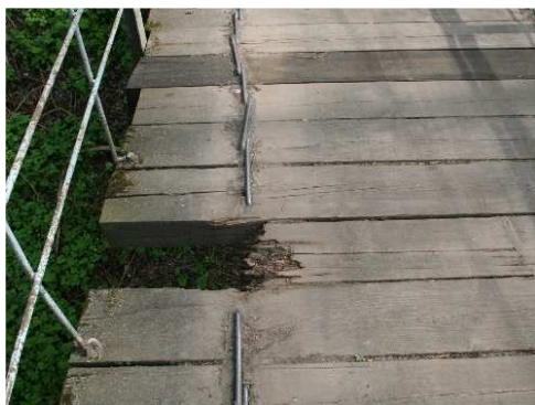
Rys. 3.143. Drewniany pokład poprzeczny pełniący funkcję pomostu oraz nawierzchni chodnika kładki – pęknięcia i próchnica wielu bali pomostu, lokalne ubytki (wyłamanie) bali, braki klamer łączących bale
