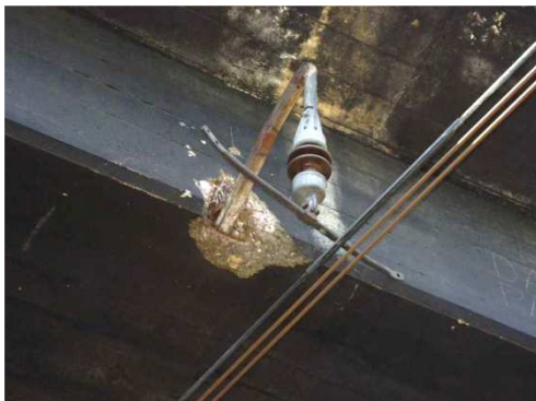
Rys. 3.373. Osłabienie zamocowania odbojnicy sieci trakcyjnej
