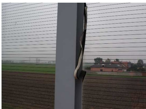
Rys. 3.339. Zniszczona uszczelka systemowa płyty/panelu ekranu przeciwhałasowego
