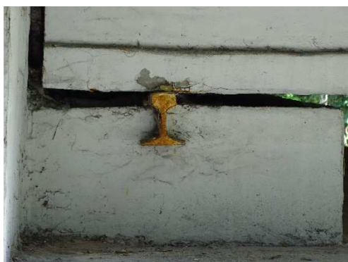
Rys. 3.218. Łożysko stalowe styczne w postaci szyny kolejowej, powierzchniowo skorodowane
