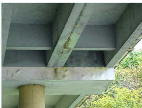
Rys. 3.112. Lokalny przeciek pomiędzy belkami prefabrykowanymi typu Korytkowego , nieprzekraczający 5% długości styków żeber pionowych
