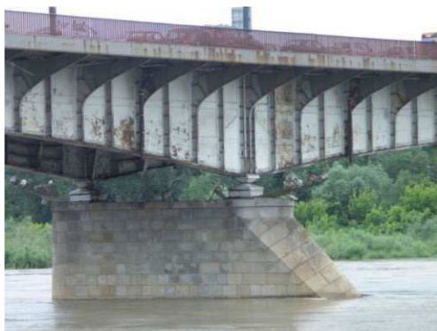
Rys. 3.187. Zniszczenie powłoki malarskiej i ogniska korozji powierzchniowej na ok. 10% powierzchni, niewpływające na nośność elementu
