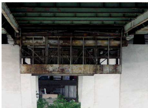
Rys. 3.382. Zniszczenie powłoki antykorozyjnej i korozja wózka rewizyjnego
