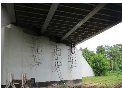
Rys. 3.387. Uszkodzenie powłok malarskich na drabinach rewizyjnych, korozja elementów stalowych zagrażająca trwałości
