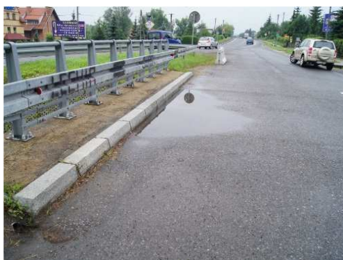
Rys. 3.100. Wadliwie działające odwodnienie powierzchniowe, lokalne zastoiska wody opadowej
