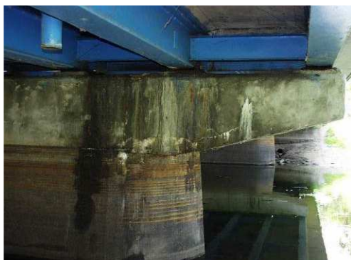
Rys. 3.270. Korozja betonu, zacieki, wykwyty, osady, rysy o rozwarości do 0.3 mm, miejscowa korozja zbrojenia
