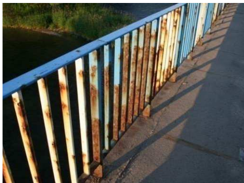
Rys. 3.52. Zniszczenie zabezpieczeń antykorozyjnych oraz zaawansowana korozja szczelin i słupków balustrady
