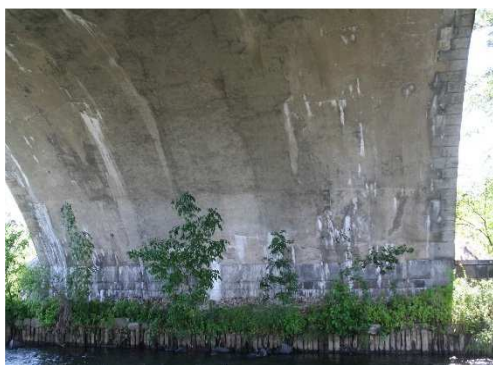
Rys. 3.163. Osady i wykwyty spowodowane przeciekami przez sklepienie, świadczące o braku skuteczności izolacji
