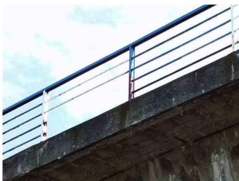
Rys. 3.62. Brak przeciągów balustrady
