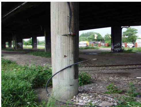
Rys. 3.372. Uszkodzenie instalacji uszynienia obiektu
