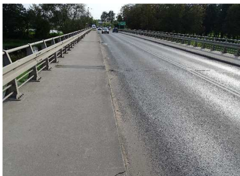
Rys. 3.25. Deformacje nawierzchni na obu pasach ruchu – koleiny o głębokości do 30 mm uniemożliwiają doływ wody opadowej do urządzeń odwadniających
