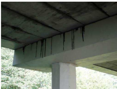
Rys. 3.230. Łożysko przekładkowe z widocznymi wyciekami bitumu, brak oznak nieprawidłowej pracy łożyska
