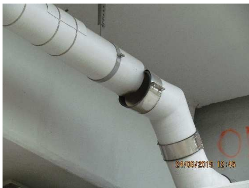
Rys. 3.95. Rozszczelnienie przewodu zbiorczego, przecieki wody na skutek uszkodzeń połączeń przewodów odprowadzających wody opadowe
