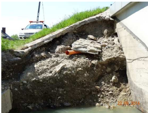
Rys. 3.12. Osunięcie i rozmycie stożka nasypu powodujące odsłonięcie skrzydełka oraz stan awaryjny nasypu przy przyczółku. Całkowite zniszczenie betonowych umocnień stożków
