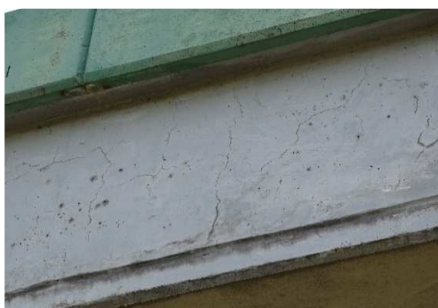
Rys. 3.155. Liczne rysy skurczowe na całej bocznej powierzchni przęśła płytowego z belek prefabrykowanych typu Kujan , niewielkie odpryski betonu
