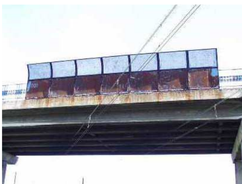
Rys. 3.69. Silna korozja osłony przeciwporażeniowej, perforacja elementu
