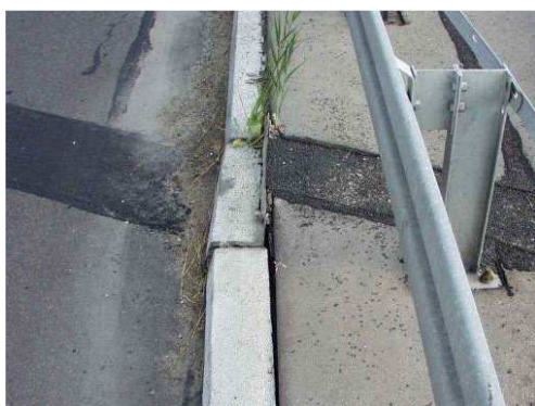
Rys. 3.50. Zanieczyszczenia, wegetacja roślin i przemieszczenie elementu krawężnika spowodowane brakiem urządzenia dylatacyjnego w jego linii
