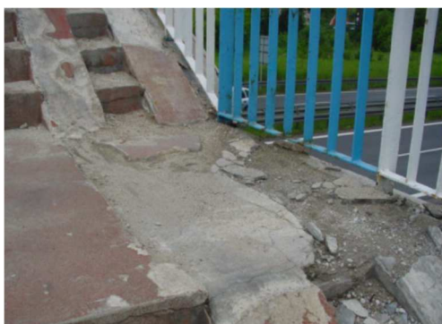
Rys. 3.376. Zniszczenie nawierzchni oraz uszkodzenie materiału konstrukcyjnego schodów i pochylni dla wózków
