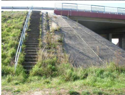
Rys. 3.101. Zanieczyszczenie ścieku na skarpię, wegetacja roślin
