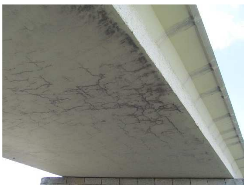
Rys. 3.154. Rozległa siatka rys skurczowych na spodniej powierzchni dźwigara płytowego, zawilgocenie wzdłuż rys
