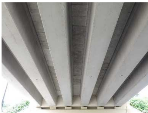
Rys. 3.130. Lokalne odpryski betonu, osady i przebarwienia na prefabrykowanych płytach pomostu, spełniających funkcję deskowania traconego, przęsła wykonanego z belek typu U
