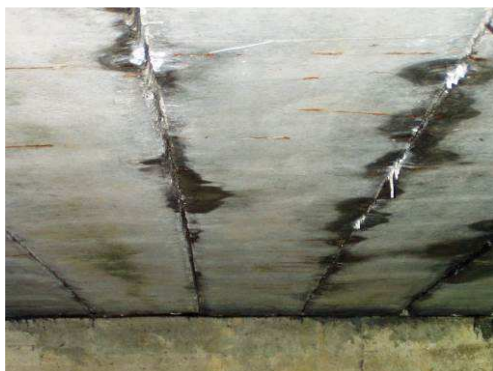
Rys. 3.111. Rozległe przecieki pomiędzy belkami prefabrykowanymi mostu płytowego, przekraczające 25% długości styków belek
