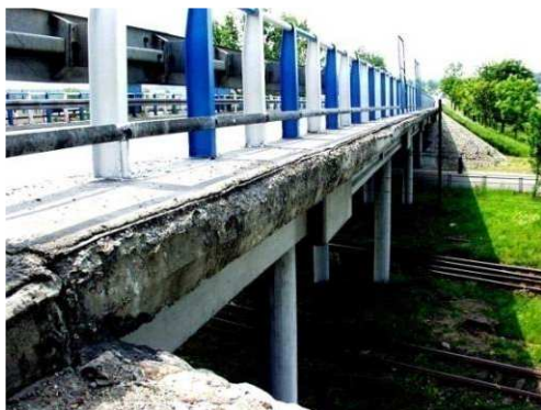
Rys. 3.79. Korozja betonu i zbrojenia oraz zanieczyszczenie gzymsu bitumem, miejscowe ubytki betonu na ok. 25% powierzchni
