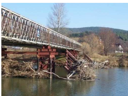
Rys. 3.297. Liczne zanieczyszczenia gromadzące się przy filarach, utrudniające spływ wody i kry lodowej
