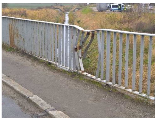
Rys. 3.57. Lokalne uszkodzenie balustrady, deformacja poręczy i szczeliny
