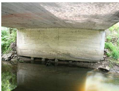
Rys. 3.264. Podmycie fundamentu przyczółka, częściowo odsłonięte prefabrykowane pale fundamentowe
