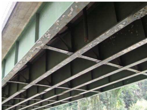
Rys. 3.186. Uszkodzenie zabezpieczenia anty-korozyjnego, złuszczenie powłoki malarskiej na ok. 10% powierzchni dźwigarów
