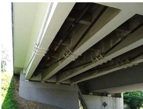
Rys. 3.363. Lokalne zanieczyszczenia osłon (rury HDPE) zewnętrznych kabli sprężających niemające wpływu na estetykę i trwałość
