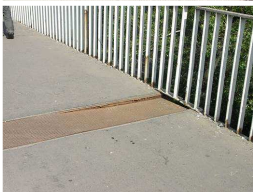
Rys. 3.242. Przemieszczenie (obniżenie) przekrycia z blachy stalowej urządzenia dylatacyjnego o ponad 10 mm
