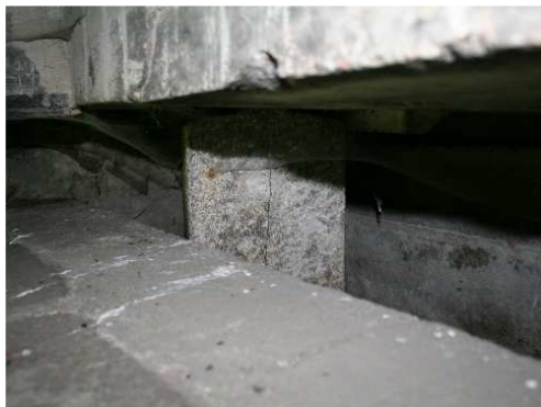
Rys. 3.231. Łożysko kamienne wahaczowe – widoczne pionowe pęknięcia/rysa pomiędzy przegubami. Uszkodzenie ma charakter przeciążeniowy
