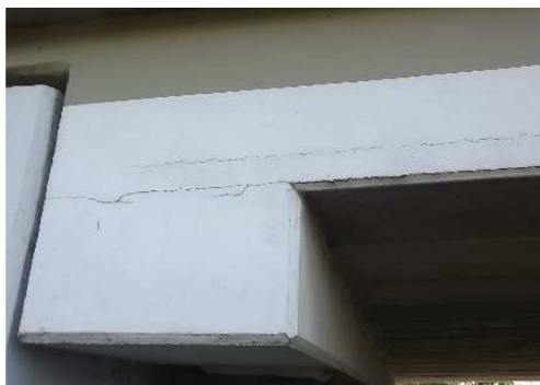
Rys. 3.160. Rysy w spójnościach technologicznych przęsa płytowego z belek typu Kujan , rysa na styku poprzecznicy podporowej z dolną krawędzią belki Kujan , rysa wzdłuż powierzchni bocznej przęsa w styku półki dolnej belki Kujan z monolitycznym nadbetonem
