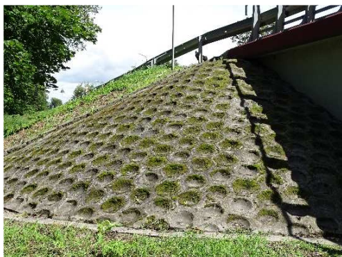
Rys. 3.3. Wegetacja mchów na betonowych umocnieniach stożków (zagrożenie korozją biologiczną), zanieczyszczenia występujące na ponad 30% powierzchni umocnień, zagrażające trwałości stożków. Początki korozji betonu
