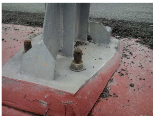
Rys. 3.63. Korozja śrub kotwiących słupki bariery ochronnej, brak kapturków zabezpieczających kotwy, zarysowania i odspojenie podlewki od podłoża
