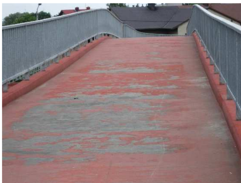
Rys. 3.38. Zniszczenie nawierzchni z żywicy epoksydowej na ponad 30% powierzchni chodnika kładki
