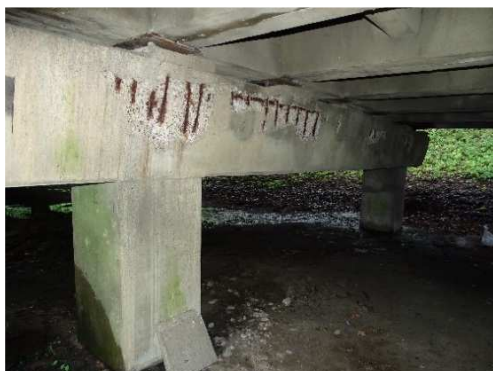
Rys. 3.282. Ubytki betonu oczepu filara spowodowane korozją zbrojenia oraz przeciekiem przez nieszczelne urządzenie dylatacyjne. Wegetacja porostów
