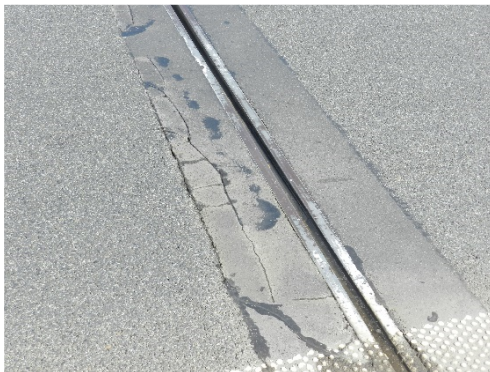
Rys. 3.249. Uszkodzenie strefy przejściowej z asfaltu lanego wzdłuż skrajnych profili urządzenia jednomodułowego, zarysowanie w spojeniu technologicznym asfaltu lanego z nawierzchnią jezdni/dojazdu z SMA
