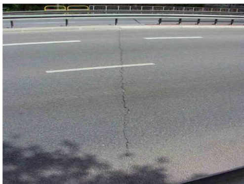
Rys. 3.239. Pęknięcie pojedyncze nawierzchni nad krawędzią płyty pomostu (uciąglenie nawierzchni), strefa dylatacyjna niewykazująca przecieków
