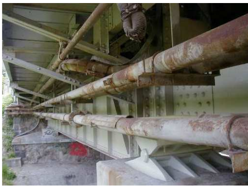
Rys. 3.366. Zniszczenie zabezpieczeń antykorozyjnych i korozja urządzeń obcych
