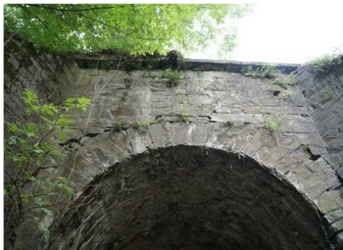
Rys. 3.145. Odspojenie ściany bocznej od sklepienia kamiennego, ubytki materiału ściany bocznej, wegetacja roślinności Kod uszkodzenia: UK, LK, RK, WK Ocena: 2
