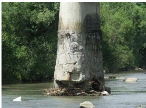
Rys. 3.269. Ubytki korpusu filara mające wpływ na jego bezpieczeństwo
