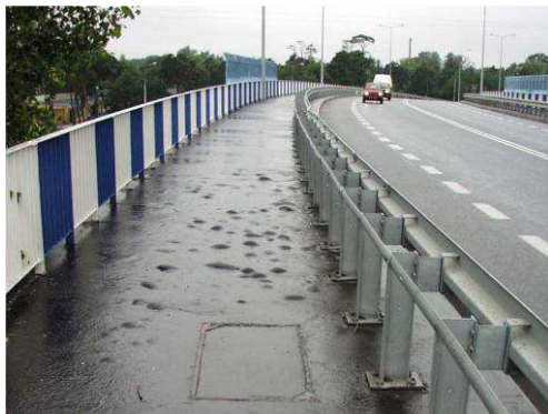
Rys. 3.35. Deformacje nawierzchni bitumicznej do 20 mm na 10% powierzchni chodnika
