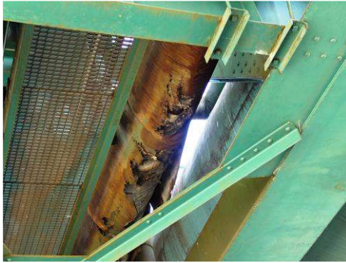
Rys. 3.370. Korozja perforacyjna osłony i ubytki izolacji ciepłociągu
