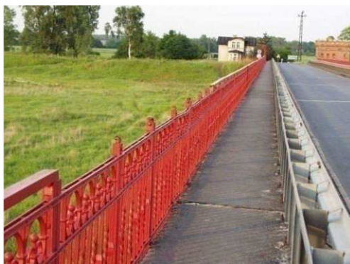
Rys. 3.61. Brak poręczy na długości 6 m, tj. ok. 5% długości balustrady, deformacje części wypełniających balustradę, miejscowe braki łączników (nitów)
