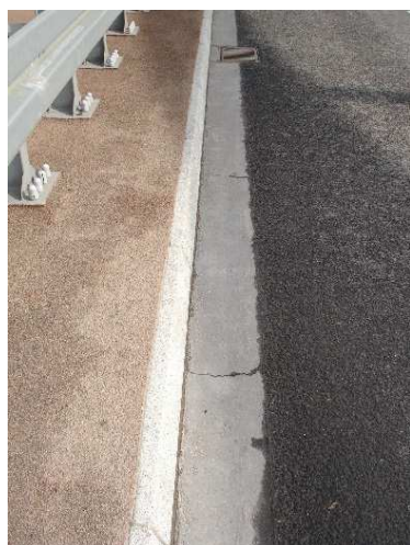
Rys. 3.34. Regularne rysy poprzeczne na całej długości ścieku przykrawężnikowego w formie przeciwspadku, którego górną powierzchnię wykonano z żywicy
