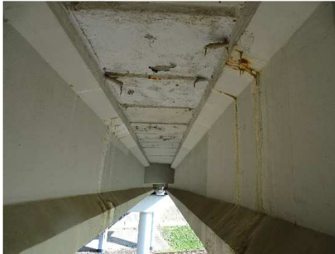
Rys. 3.120. Lokalny przeciek przez płytę pomostu, osady, wykwity oraz uszkodzenie antykorozyjnych powłok ochronnych
