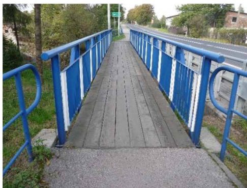
Rys. 3.141. Drewniany pokład podłużny pełniący funkcję pomostu oraz nawierzchni chodnika kładki. Przebarwienie i zawilgocenie desek wskazuje na zużycie się środków impregacyjnych
