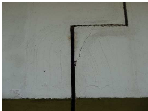
Rys. 3.311. Rysa na bocznej powierzchni przegubu. Nie stwierdzono zarysowania po przeciwnej stronie przegubu
