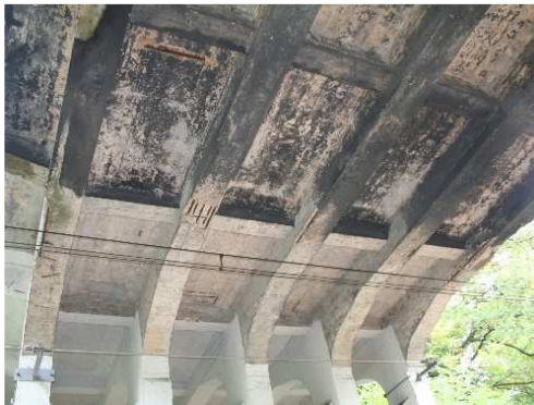
Rys. 3.121. Ubytki i korozja betonu oraz korozja odsłoniętego zbrojenia, wykwity (białe osady), zanieczyszczenie sadzą spodu płyty pomostu i dźwigarów
