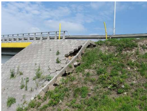
Rys. 3.13. Lokalny ubytek i rozmycie nasypu drogowego (do 10% powierzchni) pod betonowymi elementami umocnienia stożków mogące powodować zagrożenie trwałości skarpy
