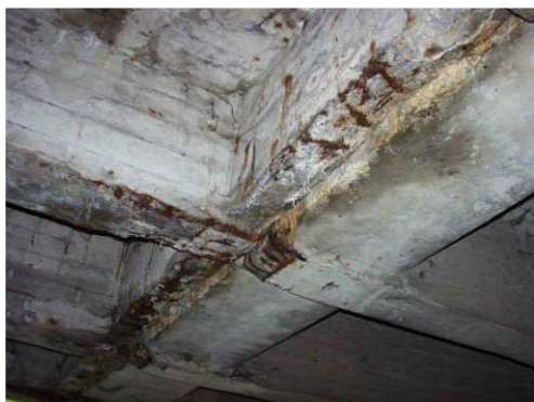
Rys. 3.310. Korozja i ubytki betonu w obrębie przegubu, korozja zbrojenia, zanieczyszczenia szczeliny dylatacyjnej
