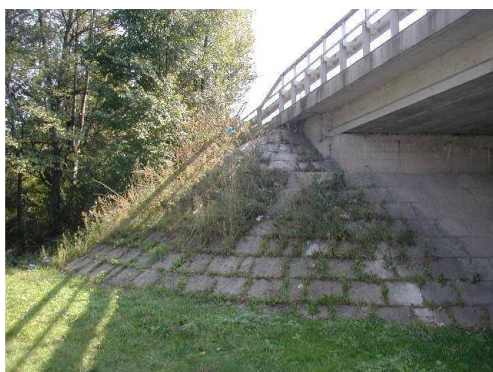
Rys. 3.6. Wegetacja zagrażająca trwałości stożka nasypu. Korozja betonowych elementów umocnienia
