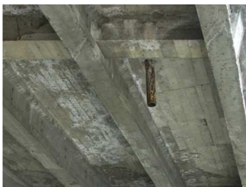
Rys. 3.125. Przecieki wody przez płytę pomostu, zacieki i wykwyty na ok. 50% powierzchni pomostu, świadczące o korozji ługującej betonu, ubytki betonu
