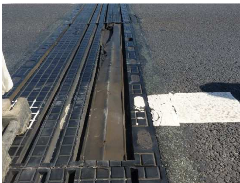
Rys. 3.244. Zniszczenie części urządzenia dylatacyjnego – zniszczenie fragmentu blokowej taśmy dylatacyjnej, urządzenie wykazujące niewielkie przecieki
