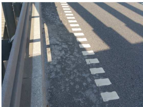
Rys. 3.91. niesprawne odwodnienie z poziomu izolacji płyty pomostu, lokalny brak drożności/skuteczności drenażu, wysięki wody i lokalne zastoiska na nawierzchni jezdni
