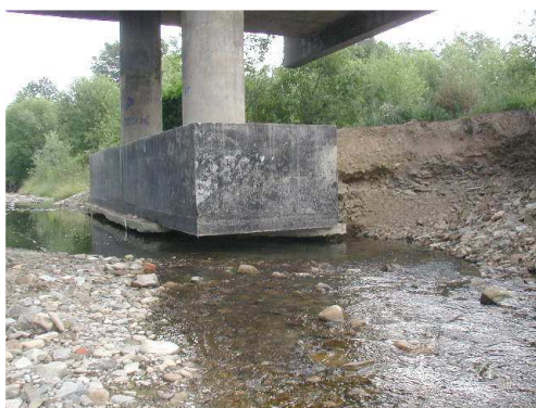
Rys. 3.276. Podmycie fundamentu filara posadowionego bezpośrednio, obejmujące ok. 25% powierzchni ławy
