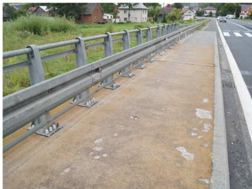
Rys. 3.40. Lokalne ubytki nawierzchni z żywicy epoksydowej na 10% powierzchni chodnika
