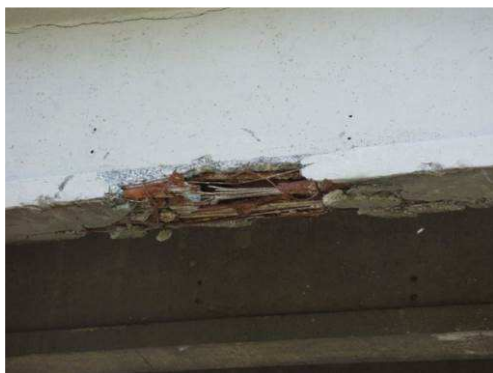
Rys. 3.173. Uszkodzenie skrajnego dźwigara kablobetonowego na skutek uderzenia pojazdu, ubytki betonu, pęknięcie kabli sprężających
