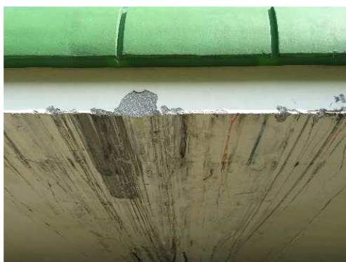
Rys. 3.170. Uszkodzenie dźwigara płytowego z betonu monolitycznego na skutek uderzenia przez pojazd nienormalny, odprysk i zarysowanie betonu, uszkodzenie antykorozyjnych powłok ochronnych
