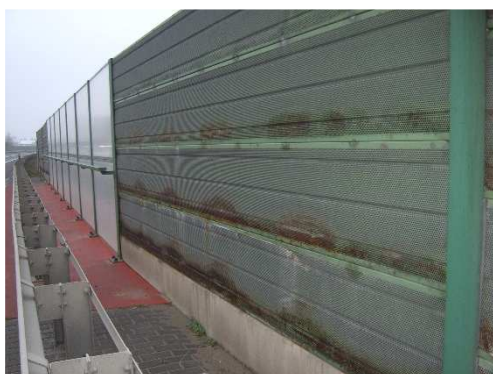
Rys. 3.337. Uszkodzenie powłoki malarskiej oraz korozja powierzchniowa na wypełnieniu kasetowym ekranu przeciwhałasowego
