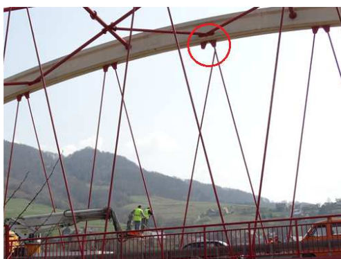
Rys. 3.361. Zerwanie wieszaka w moście łukowym ze ściągiem. W kilku najdłuższych wieszakach, w miejscu ich połączenia z blachami węzłowymi, pęknięcia obejmujące ok. 50% przekroju wieszaków. Dźwigar w stanie przedawaryjnym
