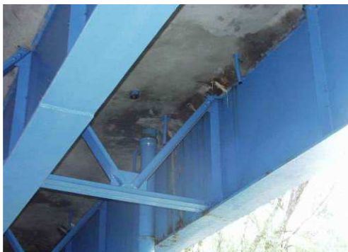
Rys. 3.107. Lokalne przecieki w sąsiedztwie wpustu i sączków – powierzchnia przecieków nieprzekraczająca 5% powierzchni płyty pomostu
