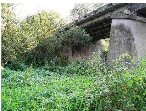
Rys. 3.299. Bujna roślinność ograniczająca swobodny przepływ wielkiej wody i przewietrzanie ustroju. W zimie będzie utrudniony spływ kry lodowej
