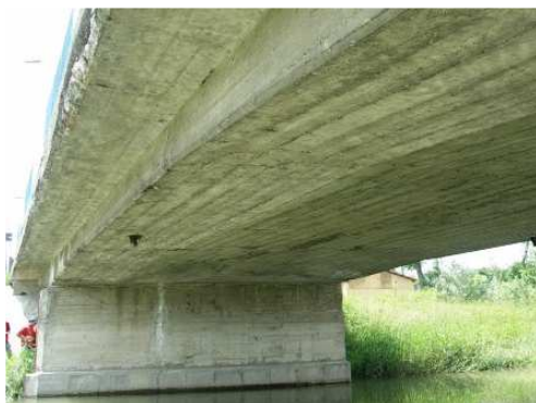
Rys. 3.153. Osady, wykwyty, niewielka korozja i ubytki betonu na wspornikach pochodnikowych, lokalnie ubytki betonu i korozja strzemion
