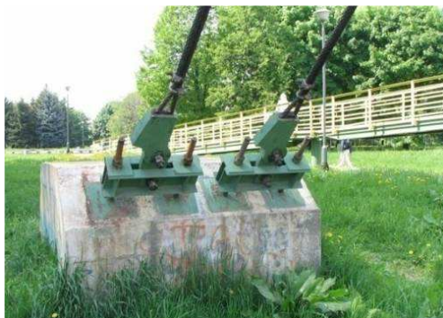
Rys. 3.347. Niewielka, nieprzekraczająca 5% powierzchni, korozja elementów stalowych zakotwienia ciągów, rysy skurczowe na betonowym bloku kotwiącym o rozwarości do 0.5 mm
