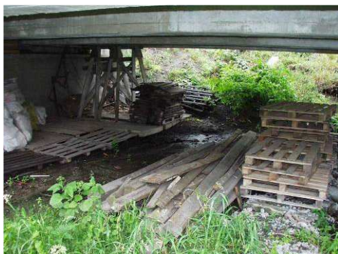
Rys. 3.298. Zgromadzone pod mostem materiały zagrażające trwałości i bezpieczeństwu konstrukcji (zagrożenie pożarem)
