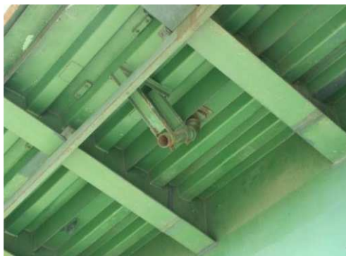
Rys. 3.133. Miejscowe zniszczenie powłoki antykorozyjnej
