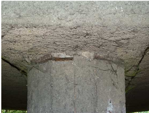
Rys. 3.228. Przegubowe połączenie filara z płytową konstrukcją ustroju nośnego. Łożysko przegubowe betonowe z ograniczoną możliwością obrotu, elementy deskowania z okresu budowy ograniczają obrót przegubu
