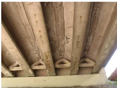
Rys. 3.123. Ubytki betonu i korozja odsoniętego zbrojenia w półkach górnych belek Płońsk, białe osady, zawilgocenie i ubytki betonu w monolitycznych zamkach belek
