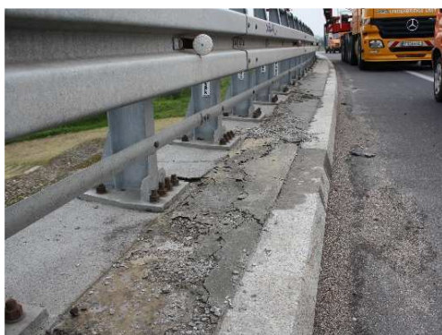
Rys. 3.41. Złuszczenie i ubytki nawierzchni z żywicy epoksydowej, korozja i ubytki betonu pod nawierzchnią. Zniszczenia występują na ponad 30% powierzchni poboczny technicznych wyniesionych
