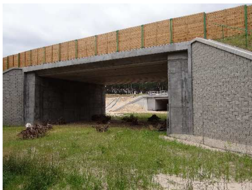
Rys. 3.304. Teren pod przejściem dolnym dla dużych zwierząt bez uszkodzeń, właściwie utrzymany Kod uszkodzenia: - Ocena: 5
