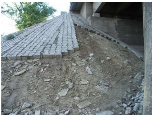
Rys. 3.14. Brak ok. 50% elementów betonowych umacniających stożek
