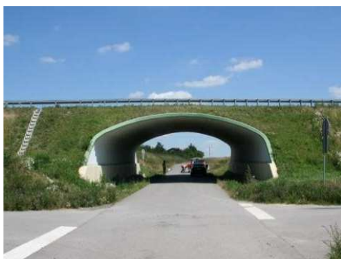
Rys. 3.17. Wegetacja roślin wymagająca wykonania prac pielęgnacyjnych oraz pogarszająca estetykę nasypu
