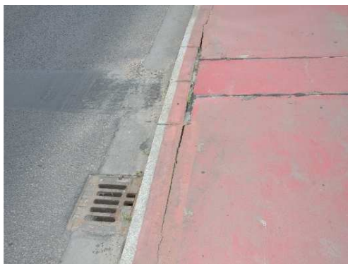
Rys. 3.47. Pęknięcie pojedyncze pomiędzy krawężnikiem a betonem kapy w strefie bitumicznego przykrycia dylatacyjnego
