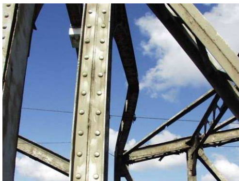
Rys. 3.195. Deformacje stężenia na skutek uszkodzenia mechanicznego – uderzenia pojazdu
