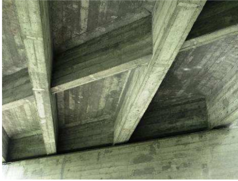
Rys. 3.119. Niewielkie, miejscowe zanieczyszczenia i osady – pomost w dobrym stanie technicznym
