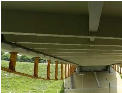
Rys. 3.362. Lokalne zanieczyszczenia osłon (rury HDPE) zewnętrznych kabli sprężających niemające wpływu na estetykę i trwałość
