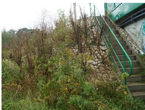
Rys. 3.5. Wegetacja roślin na kamiennych umocnieniach stożków zagrażająca trwałości, obłuzowanie kamiennych elementów umocnienia występujące na ok. 30% powierzchni
