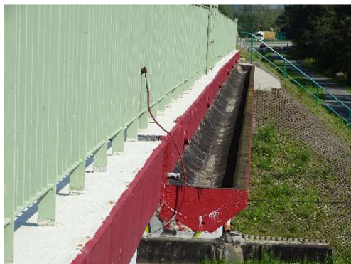
Rys. 3.93. uszkodzenia żelbetowego koryta odwadniającego – zarysowania betonu na czole i spodniej powierzchni koryta, osady i wykwyty, niewielkie zanieczyszczenie piaskiem, uszkodzenia powłoki malarskiej
