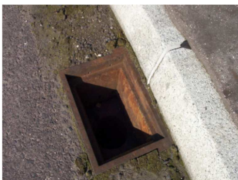
Rys. 3.97. Brak kratki ściekowej wpustu
