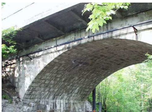
Rys. 3.205. Przecieki wody, osady i wykwyty na powierzchni sklepienia świadczące o korozji spoin elementów sklepienia
