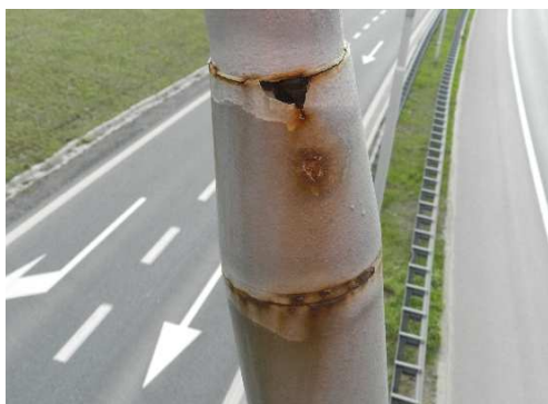
Rys. 3.356. Pęknięcie osłony kabla, rdzawy wyciek
