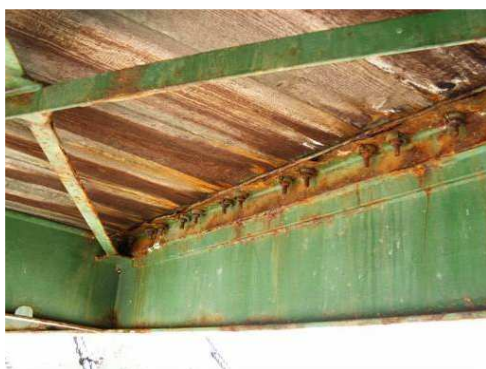
Rys. 3.142. Liczne zawilgocenia i przecieki oraz korozja drewna (gnicie) powodująca zmniejszenie przekroju o ok. 20%
