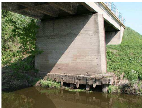
Rys. 3.275. Częściowe podmycie fundamentu filara
