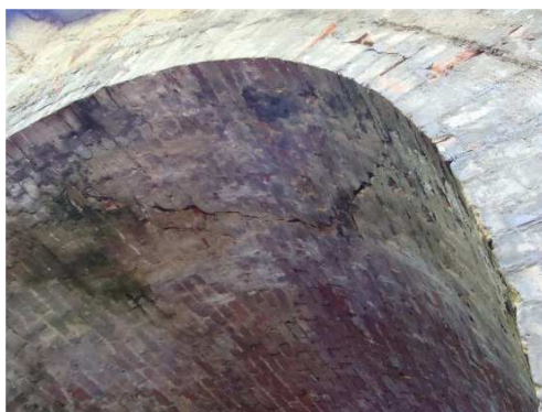
Rys. 3.207. Rozległe osady i wykwyty na spodniej powierzchni sklepienia wskazujące na przecieki, pęknięcie cegieł w strefie klucza, ubytki materiału ze spoin
