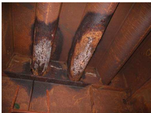
Rys. 3.138. Pomost ortotropowy wykonany ze stali trudnordzewiejącej, na elementach pomostu wyraźne lokalne, brunatne przebarwienia oraz białe osady i wykwity zawierające jony chlorku, mikrorysy na spodzie żeber podłużnych oraz w spoinach łączących żebra podłużne z blachą pomostu
