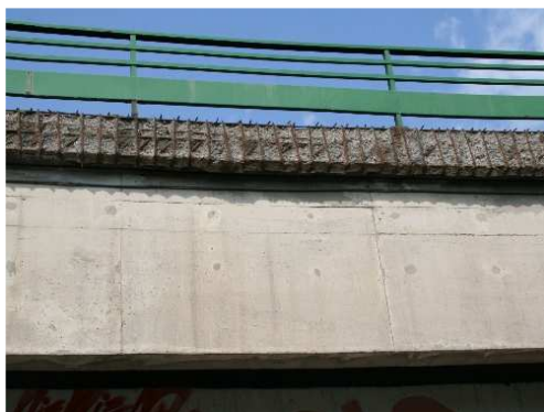
Rys. 3.80. Korozja i ubytki betonu, odsłonięte zbrojenie na ok. 50% powierzchni belki podporęczowej
