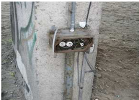
Rys. 3.389. Korozja i uszkodzenie pokrywy skrzynki bezpiecznikowej/rozdzielczej
