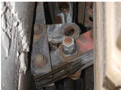
Rys. 3.245. Uszkodzenie mechanizmu nożycowego dwumodułowego urządzenia dylatacyjnego. Brak sworzni i nakrętek, brak płaskownika zewnętrznego. W strefie dylatacyjnej widoczne niewielkie przecieki
