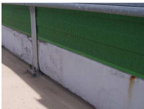
Rys. 3.328. Ekran przeciwhałasowy z wypełnieniem kasetowym oraz betonowym panelem dolnym, uszkodzenie powłok ochronnych, rysy skurczowe oraz ogniska korozji zbrojenia na panelach betonowych, zmatowienie powłok malarskich ze śladami korozji powierzchniowej na stalowym wypełnieniu kasetowym
