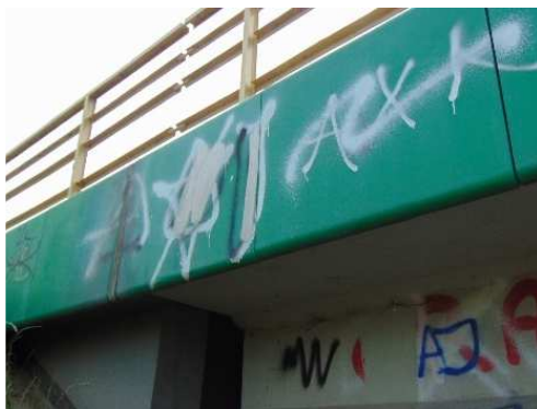
Rys. 3.72. Rozległe zanieczyszczenia graffiti pogarszające estetykę obiektu
