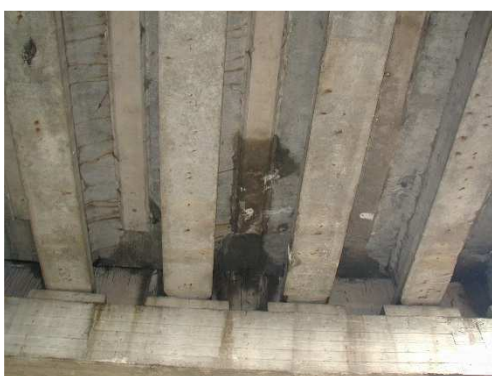
Rys. 3.109. Lokalne przecieki przez zamek belki typu Płońsk oraz w sąsiedztwie dylatacji – powierzchnia przecieków nieprzekraczająca 5% powierzchni płyty pomostu
