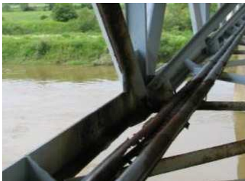
Rys. 3.369. Ubytki korozyjne osłon przewodów telekomunikacyjnych
