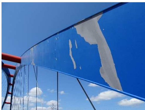
Rys. 3.198. Lokalna delaminacja i ubytki powłoki nawierzchniowej stalowego dźwigara łukowego. Łączne uszkodzenie powłoki nawierzchniowej do 5% powierzchni
