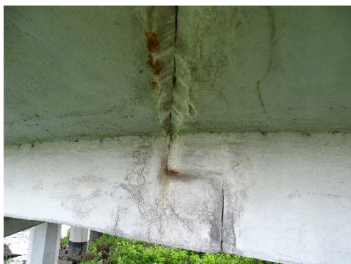
Rys. 3.313. Brak możliwości obrotu/przesuwu, intensywne przecieki wody, beton skorodowany w obrębie przegubu, rdzawe zacieki świadczące o korozji zbrojenia, osady wypełniające przegub
