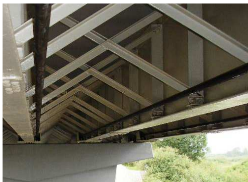
Rys. 3.353. Cięgna wzmacniające dźwigary stalowe w dobrym stanie
