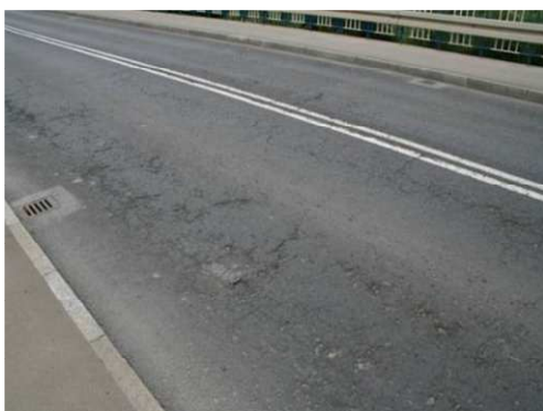
Rys. 3.29. Pęknięcia siatkowe z wykruszeniami występujące na ok. 20% powierzchni jezdni, miejscowe ubytki o wymiarach mniejszych niż 0.1 x 0.1 m
