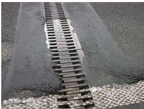
Rys. 3.250. Deformacja asfaltu lanego strefy przejściowej wzdłuż segmentów palczastego urządzenia dylatacyjnego, deformacje przekraczające 20 mm
