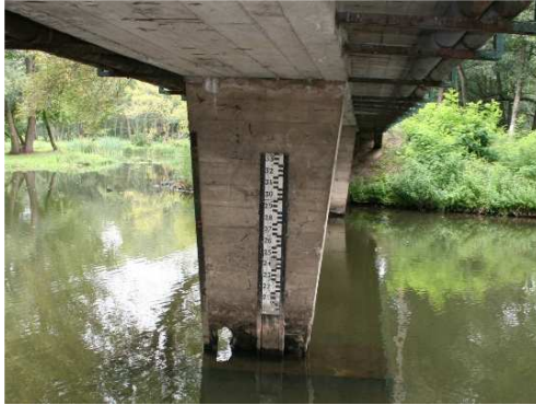
Rys. 3.393. Znak pomiarowy (wodowskaz) wykazuje uszkodzenia obniżające jego czytelność
