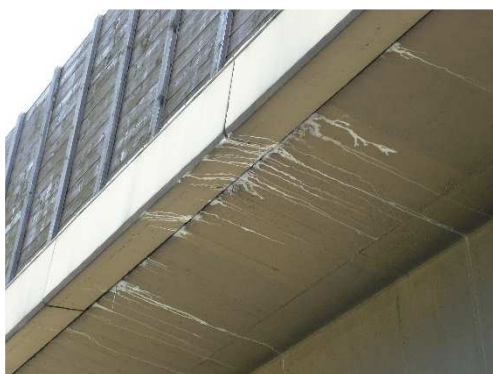
Rys. 3.104. Wadliwe odwodnienie izolacji, tj. niewłaściwe spadki pomostu, brak sączków lub sączki niedrożne
