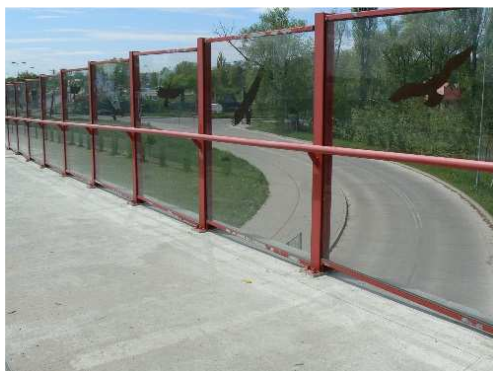
Rys. 3.336. Uszkodzenie powłoki malarskiej na stalowym obramowaniu wypełnienia płytowego ekranu przeciwhałasowego oraz rurowej poręczy
