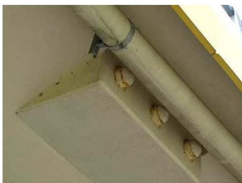
Rys. 3.351. Niewielkie zniszczenie zabezpieczeń antykorozyjnych i korozja powierzchniowa na zakotwieniach sprężenia poprzecznego
