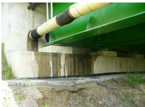
Rys. 3.88. Brak szczelności przewodu zbiorczego, przecieki w strefie kompensatora, wycieki spoza ścianki zapleczonej przyczółka
