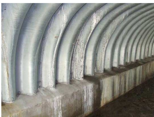
Rys. 3.118. Intensywne przecieki i liczne osady na powłoce z blachy falistej spowodowane wadliwie wykonaną izolacją i nieskutecznym drenażem odwadniającym zasypkę
