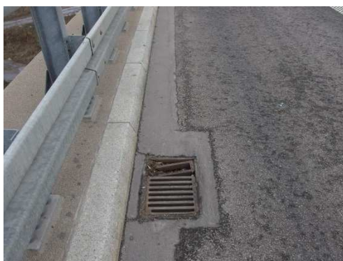
Rys. 3.96. Uszkodzona kratka ściekowa wpustu, rysy w asfalcie lanym przeciwnospadku
