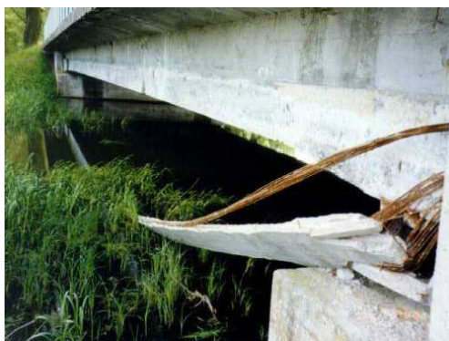
Rys. 3.357. Całkowite uszkodzenie cięgien sprężenia zewnętrznego
