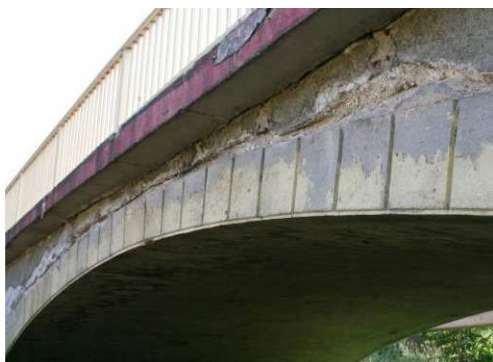
Rys. 3.146. Korozja i ubytki materiału ściany bocznej mostu sklepionego, wspornik podchodnikowy z niewielkimi zanieczyszczeniami Kod uszkodzenia: UB, KB Ocena: 3
