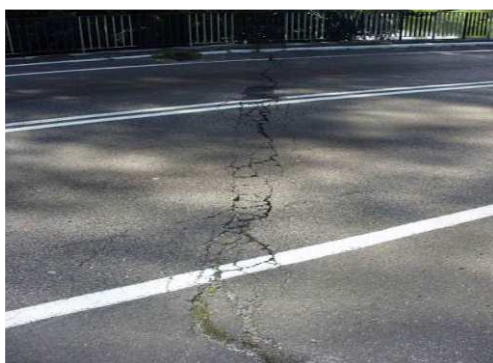
Rys. 3.238. Spękania i ubytki ucięcia nawierzchni o głębokości ponad 20 mm, widoczne intensywne przecieki na przyczółku
