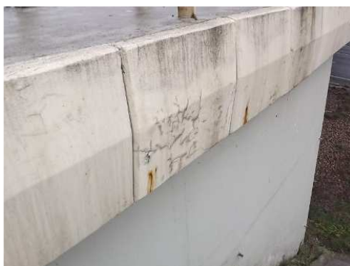
Rys. 3.73. Zanieczyszczenie zewnętrznych powierzchni desek gzymsowych pogarszające estetykę obiektu, rysy skurczowe oraz ogniska korozji zbrojenia na dekoracyjno-ochronnej powłoce nieprzekraczające 5% powierzchni desek
