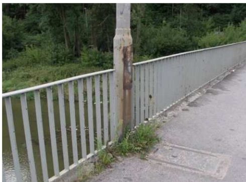
Rys. 3.367. Zniszczenie zabezpieczenia antykorozyjnego i korozja latarni oświetlającej obiekt
