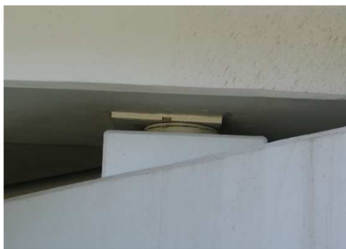
Rys. 3.213. Łożysko garnkowe wielokierunkowo przesuwne w wadliwym położeniu. W skrajnie ujemnej temperaturze otoczenia tłok łożyska znajdzie się poza górną płytą ślizgową – fotografię wykonano w okresie wysokich temperatur (+25°C)
