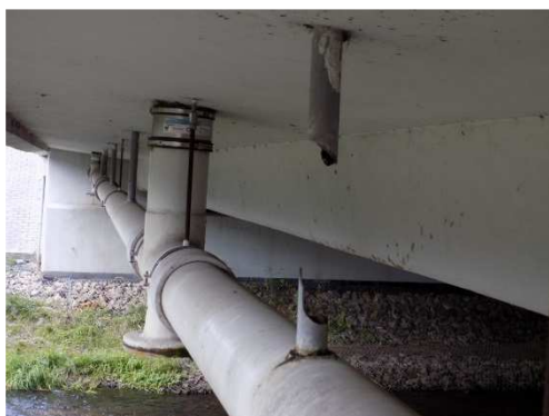
Rys. 3.94. brak ciągłości jednej rurki odpływowej sączka
