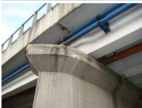
Rys. 3.285. Uszkodzenia ławy podłożyskowej (głowicy korpusu) filara spowodowane przeciekiem przez nieszczelne urządzenie dylatacyjne. Zacieki i wycieki, rysy, osady oraz zanieczyszczenie korpusu
