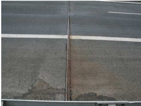
Rys. 3.248. Wadliwe położenie skrajnych profili stalowych jednomodułowego urządzenia dylatacyjnego nieadekwatne do temperatury (brak szczeliny), prawdopodobne zniszczenie neoprenowej wkładki uszczelniającej
