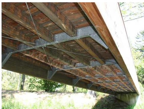
Rys. 3.140. Zawilgocenia, zacieki oraz miejscowa korozja drewna
