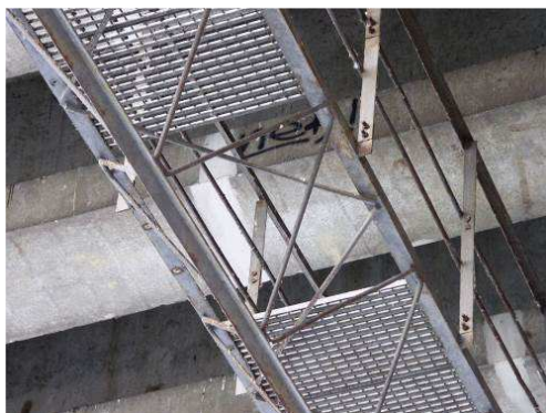
Rys. 3.384. Zniszczenie/brak fragmentu pomostu wózka rewizyjnego
