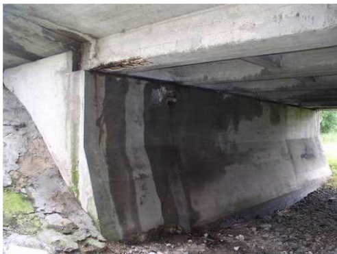
Rys. 3.243. Brak szczelności urządzenia dylatacyjnego – modułowego. Z poziomu pomostu nie stwierdzono uszkodzeń
