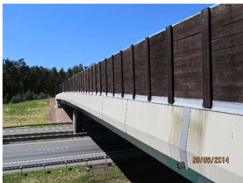
Rys. 3.332. Ekran przeciwolśnieniowy na przejściu górnym dla zwierząt. Niewielkie uszkodzenie i częściowa utrata właściwości ochronnych impregnatów i powłok na drewnianych elementach ekranów
