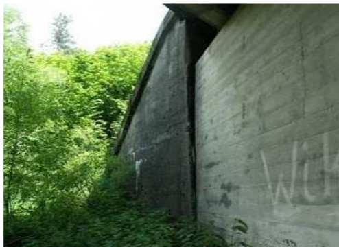
Rys. 3.316. Przemieszczenie korony skrzydła o ok. 60 mm, objawy korozji ługującej
