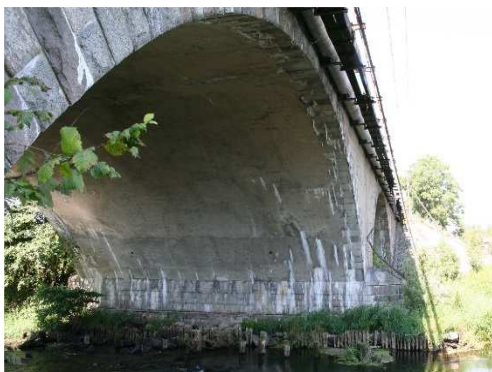
Rys. 3.116. Rozległe przecieki przez betonowe sklepienie świadczące o braku szczelności izolacji
