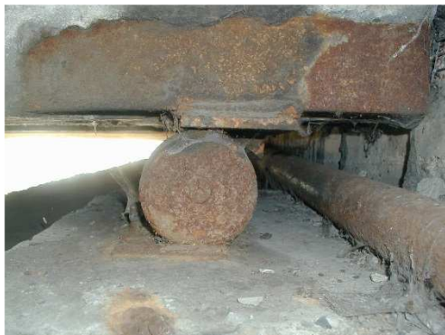
Rys. 3.212. Łożysko stalowe wałkowe skorodowane i zanieczyszczone, położenie wałka nieadekwatne do temperatury otoczenia, wskazujące na wyczerpanie możliwości przemieszczeń w sytuacji wzrostu temperatury (ocena dokonana w temperaturze +15°C)
