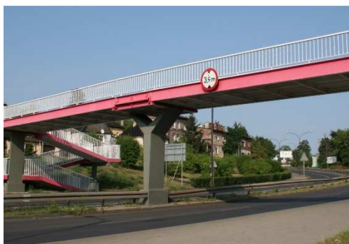
Rys. 4.10. Zbyt mała wysokość skrajni pod obiektem
