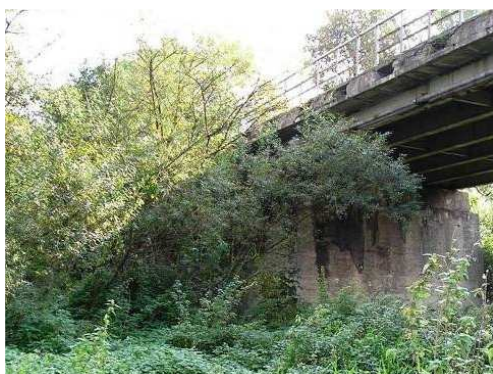
Rys. 3.4. Wegetacja roślin (drzew, krzewów) występująca na ponad 30% powierzchni nasypów, zagrażająca trwałości stożków i ich stateczności
