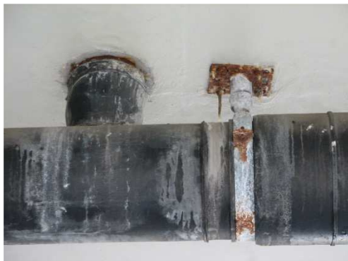
Rys. 3.99. Zaawansowana korozja zagrażająca trwałości elementów mocujących przewody odprowadzające wody opadowe, zanieczyszczenie przewodu zbiorczego
