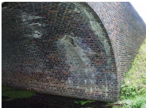
Rys. 3.204. Zacieki, osady i wykwyty na powierzchni sklepienia świadczące o korozji cegieł i ich spoin
