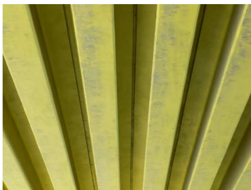
Rys. 3.152. Uszkodzenie malarskich powłok dekoracyjno-ochronnych na spodnich i bocznych powierzchniach środków belek typu T
