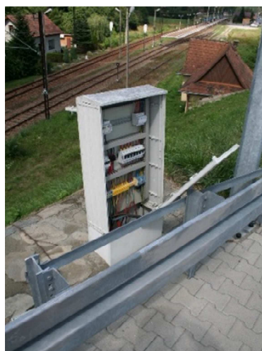
Rys. 3.388. Uszkodzenie szafy rozdzielczej/sterowniczej – zniszczone drzwi
