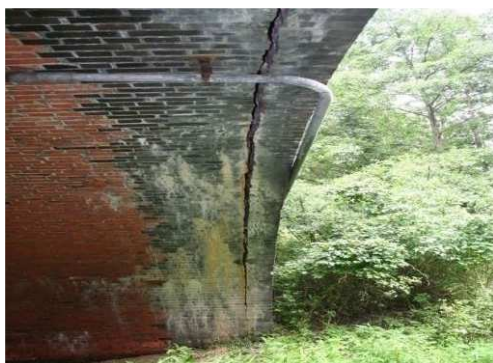
Rys. 3.147. Przemieszczenie poziome ściany bocznej i pęknięcie dźwigara – sklepienia ceglanego. Występuje zagrożenie trwałości i nośności pomostu Kod uszkodzenia: RC, PC, CT Ocena: 1
