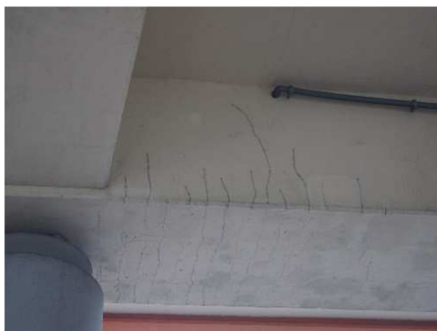
Rys. 3.157. Rysy poprzeczne na spodniej i bocznych powierzchniach dźwigara kablobetonowego nad filarem pośrednim, o rozwarości 0.15 mm
