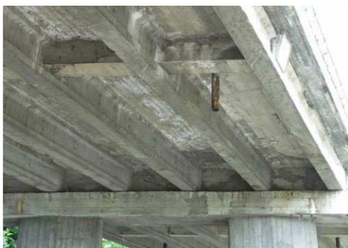
Rys. 3.110. Rozległe przecieki świadczące o braku szczelności izolacji
