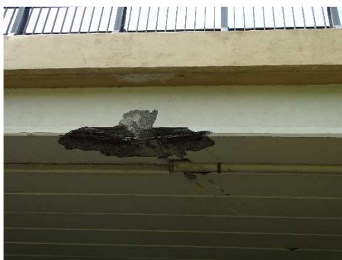
Rys. 3.171. Uszkodzenie skrajnej belki typu Kujan dźwigara płytowego na skutek uderzenia przez pojazd nienormalny, odprysk i zarysowanie betonu, zerwanie splotów sprężających oraz prętów zbrojenia miękkiego
