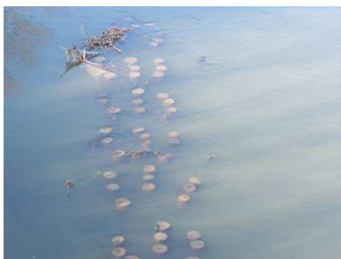
Rys. 3.301. Zbyt wysoko obcięte pale starej podpory w sąsiedztwie nowego mostu, ułatwiające gromadzenie się zanieczyszczeń i utrudniające spływ wody i lodu
