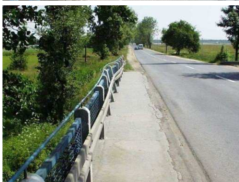
Rys. 3.59. Deformacja oraz przemieszczenie balustrady wraz z prowadnicą o ok. 15 cm, osłabione zamocowanie 2 słupków
