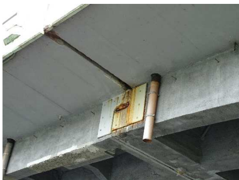
Rys. 3.312. Przecieki wody, beton skorodowany w obrębie przegubu, korozja blachy wzmacniającej boczne powierzchnie przegubu
