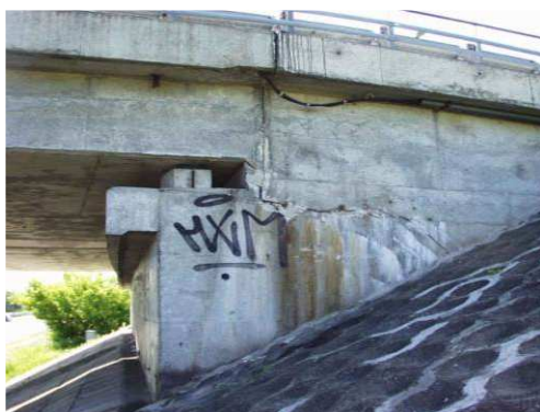
Rys. 3.182. Przemieszczenie przęsła lub przyczółka powodujące całkowity zanik szczeliny dylatacyjnej, brak możliwości swobodnego wydłużania przęsła
