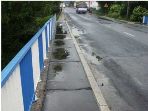
Rys. 3.37. Brak spadku umożliwiającego odpływ wody, widoczne liczne zastoiska na powierzchni większej niż 30%, brak spoin między belką podporęczową i krawężnikiem a nawierzchnią chodnika
