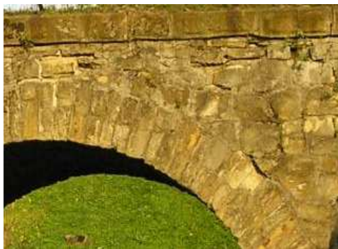
Rys. 3.144. Ubytki materiału ściany bocznej Kod uszkodzenia: UK, LK Ocena: 3
