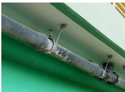
Rys. 3.89. Korozja żeliwnego przewodu zbiorczego spowodowana złym odprowadzeniem wody z sączka
