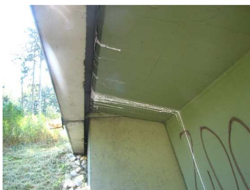
Rys. 3.113. Białe osady i stalaktyty na spodniej powierzchni wspornika płyty pomostu świadczące o wadliwym systemie odwodnienia izolacji, izolacja wywinięta na boczną powierzchnię wspornika płyty pomostu, brak uszkodzeń izolacji
