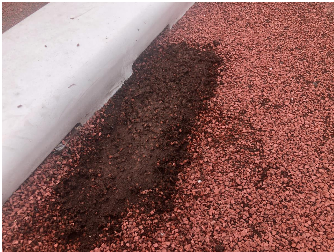
Fot. 9 Zabrudzenie nawierzchni pod nagromadzonym granulem
