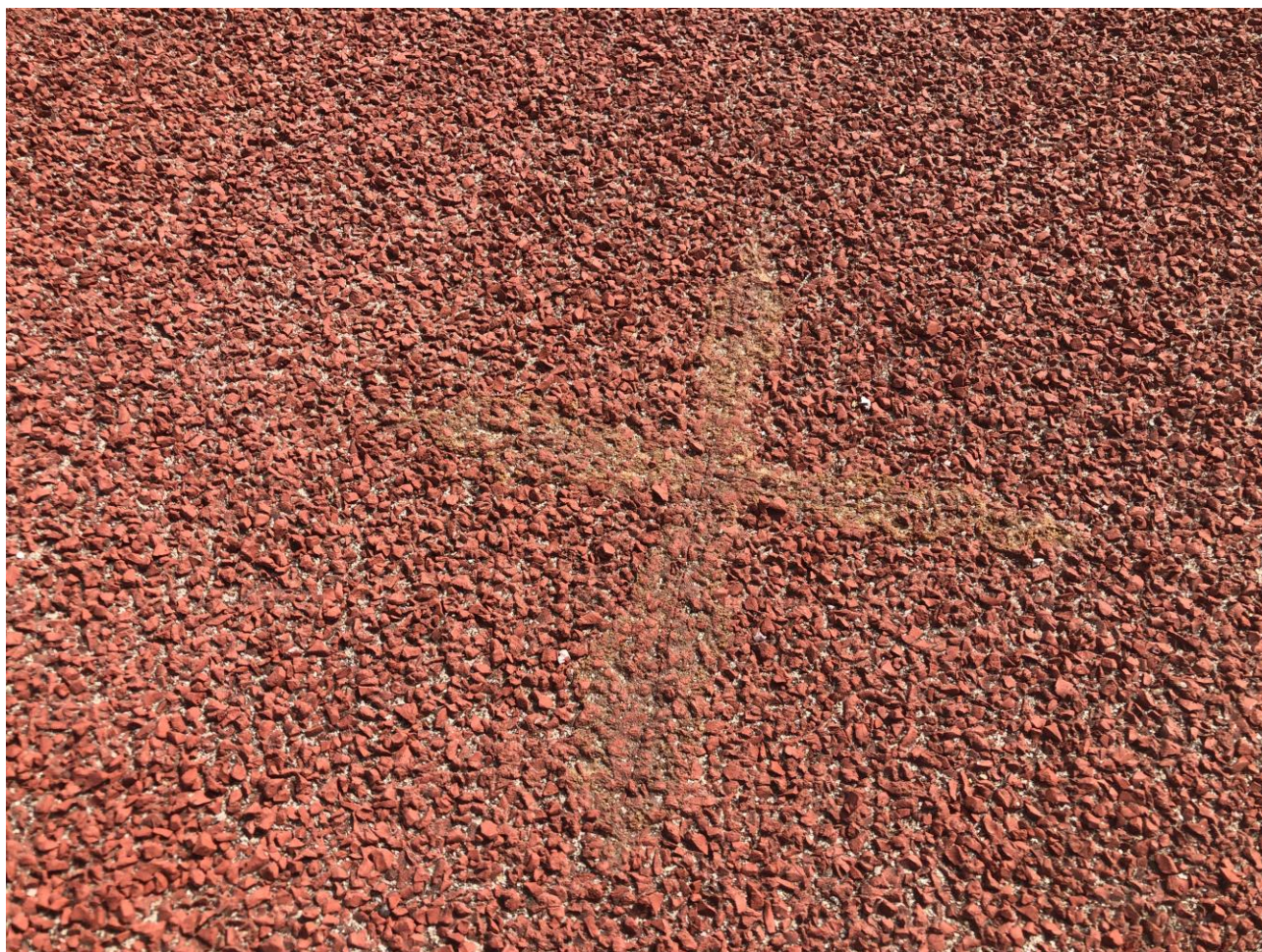
Fot. 3 Podklejone odspojenie nawierzchni od podłoża.
