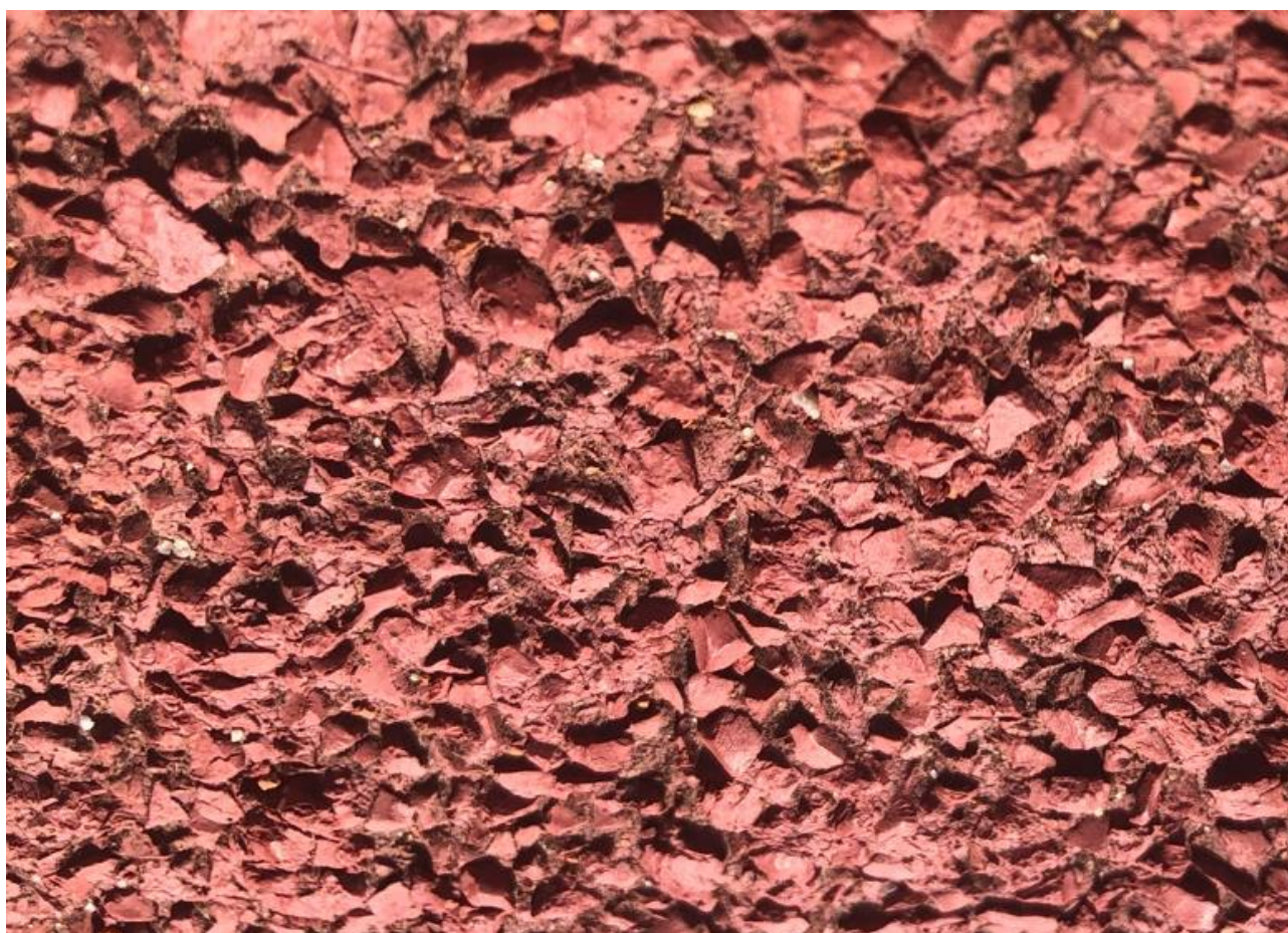
Fot. 7 Widoczne wgłębienia po utracie granulatu z warstwy wierzchniej
