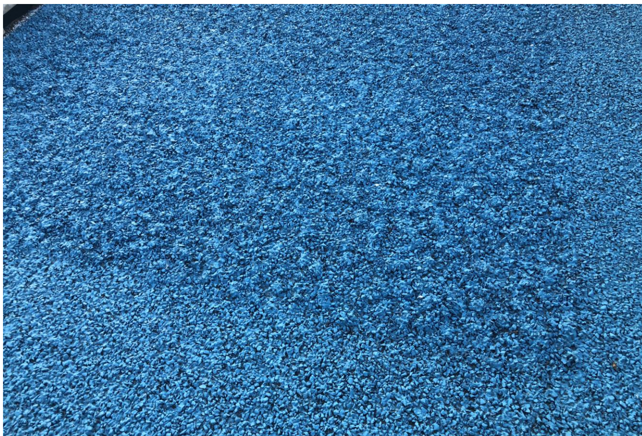
Fot. 5 Widoczna odmienna faktura warstwy użytkowej na nowo wstawionym fragmencie
