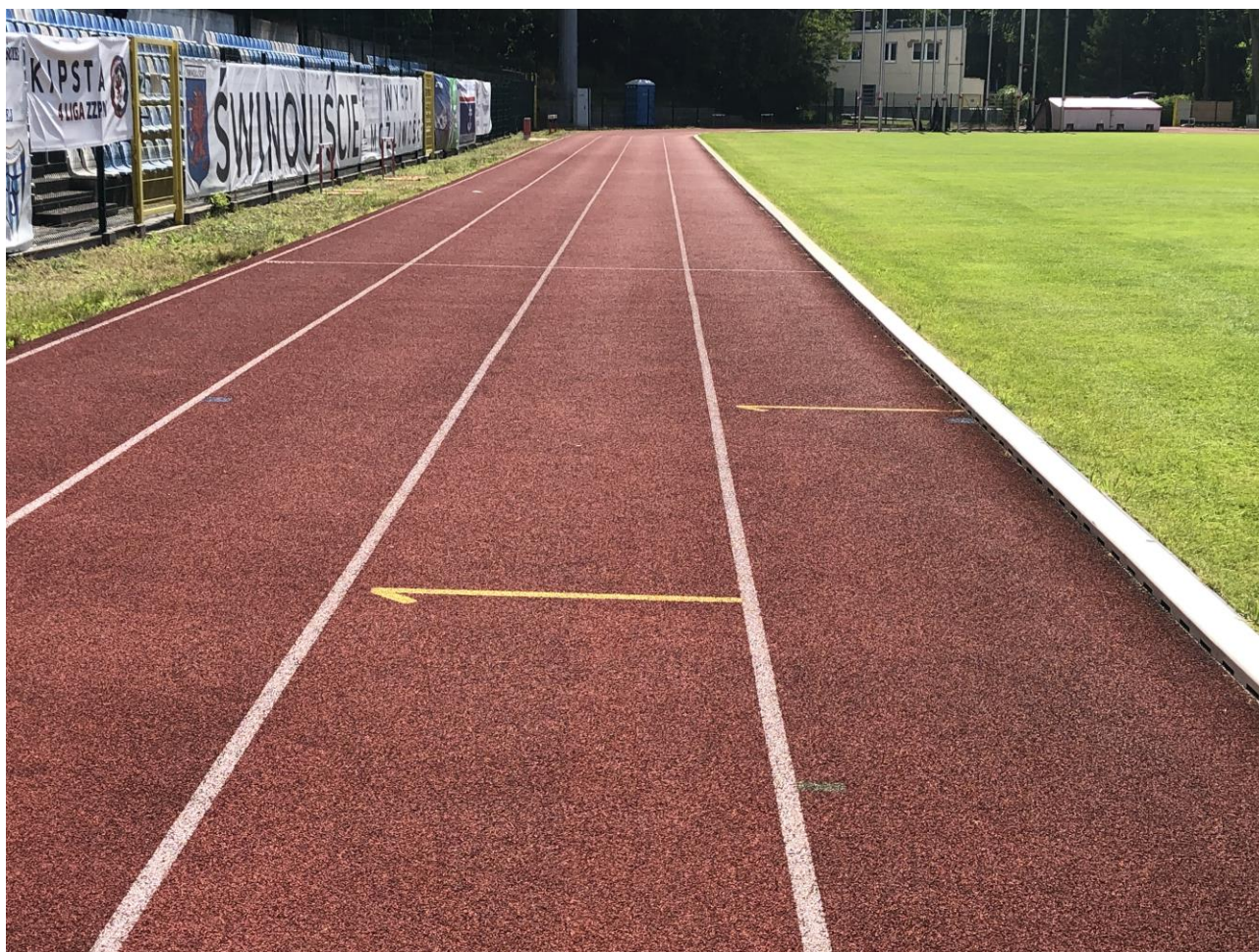
Fot. 3 Zużycie warstwy użytkowej na środkach torów biegowych i przy krawędzi odwodnienia na torze 1
