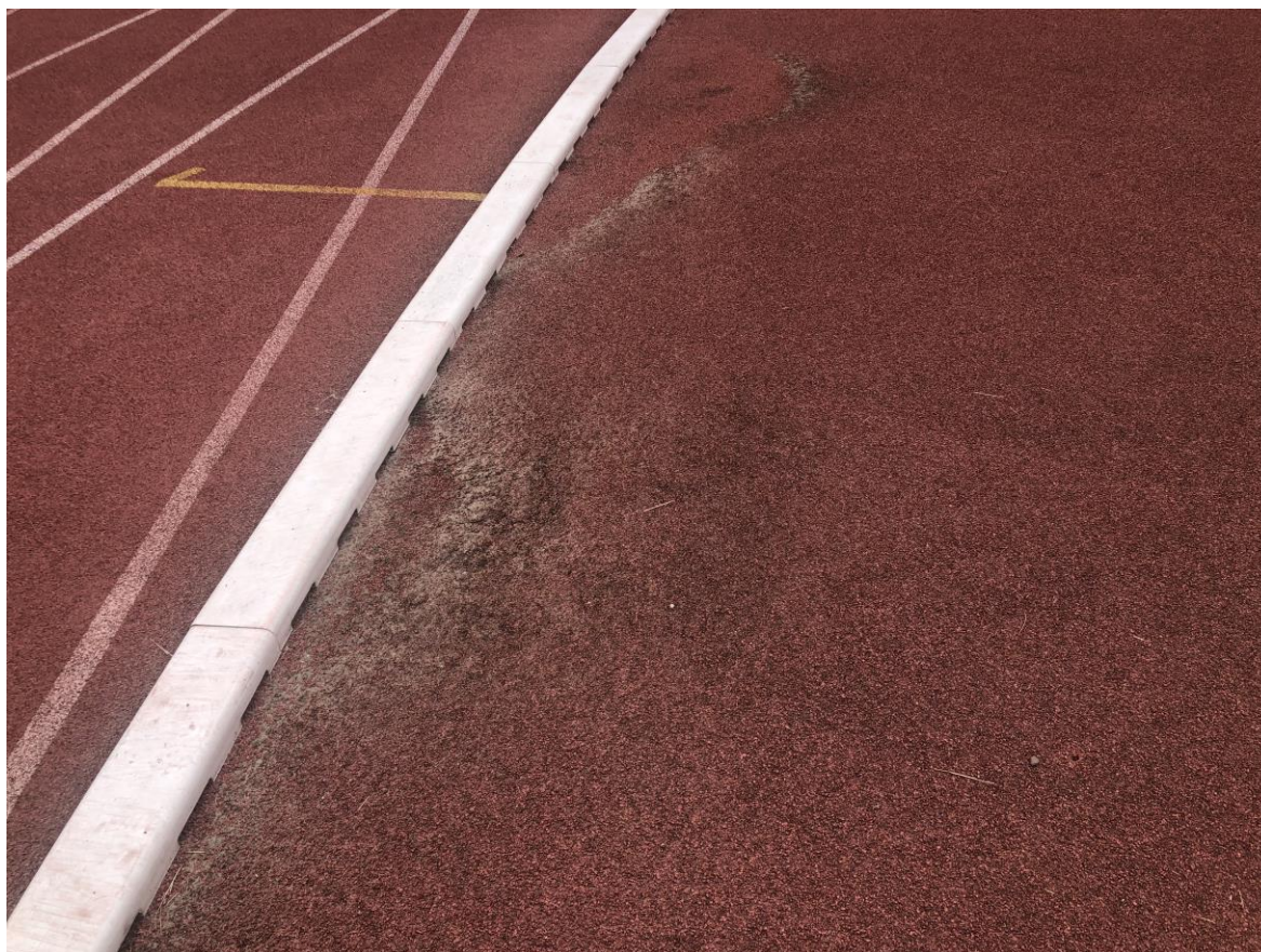
Fot. 8 Widoczne gromadzenie się luźnego granulatu EPDM przy linii odwodnienia na zakolu D
