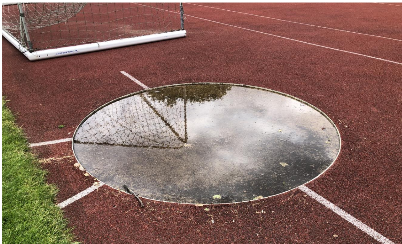
Fot. 7 Niedrożny odpływ w kole do pchnięcia kulą
