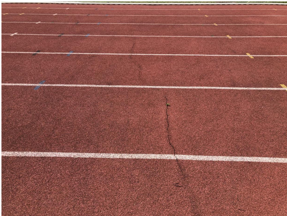
Fot. 7 Pęknięcie nawierzchni w odległości 360m tor 5-8.
