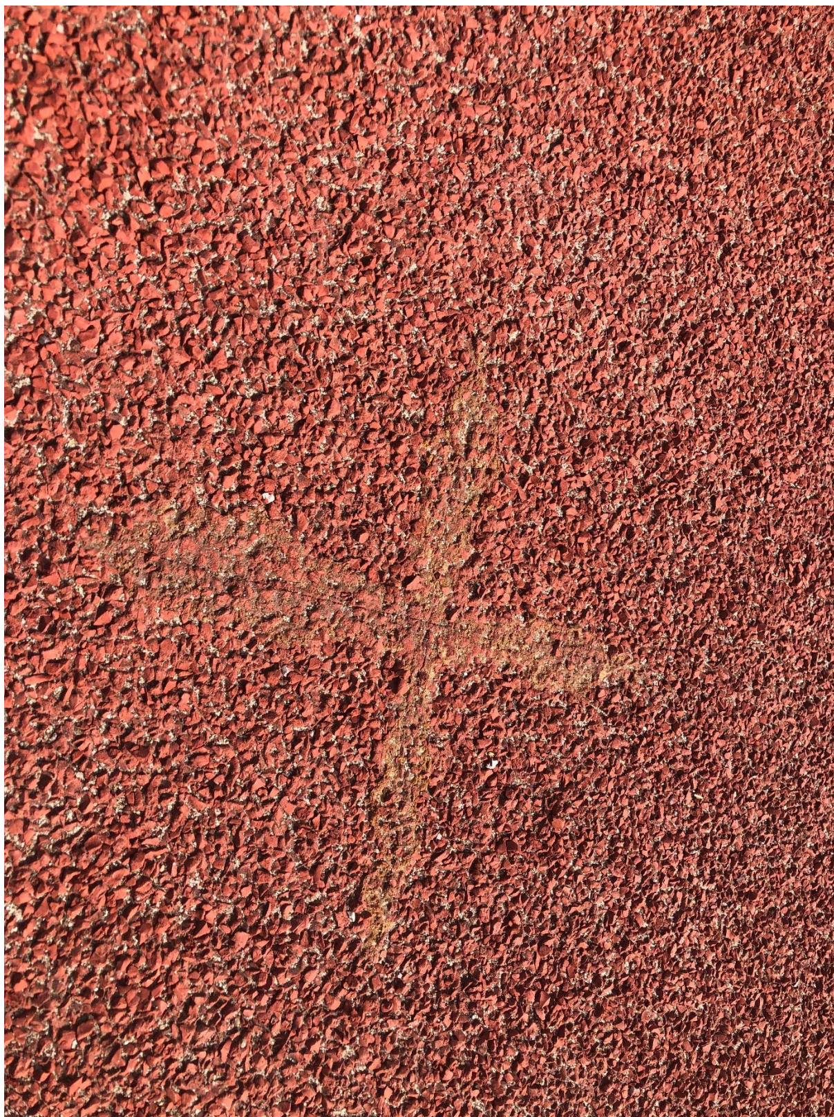
Fot. 18 Przykład lokalnej naprawy nawierzchni – najprawdopodobniej po lokalnym odspojeniu się nawierzchni od podłoża.
