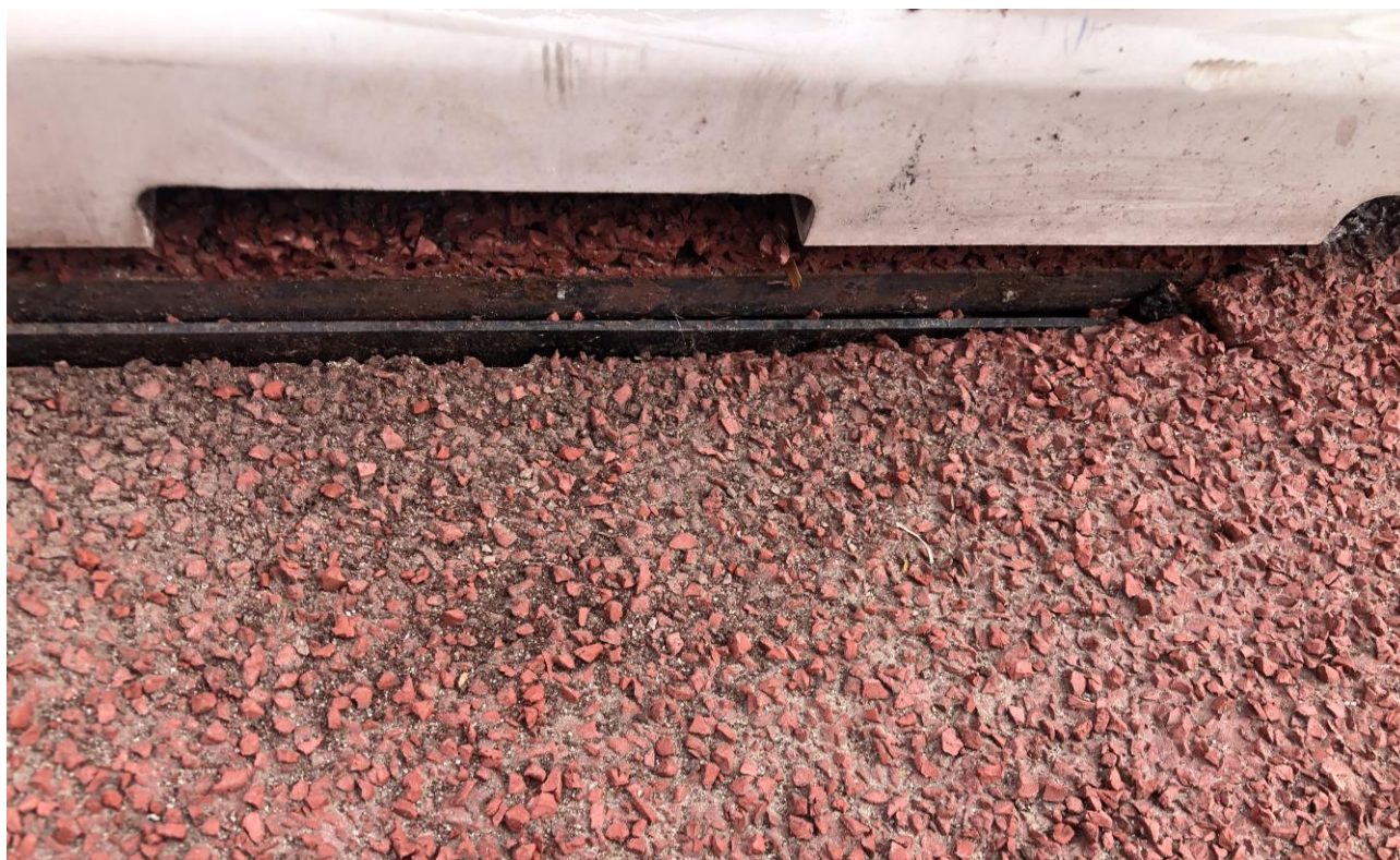
Fot. 5 Zapadnięcie podbudowy przy linii odwodnienia (260m)
