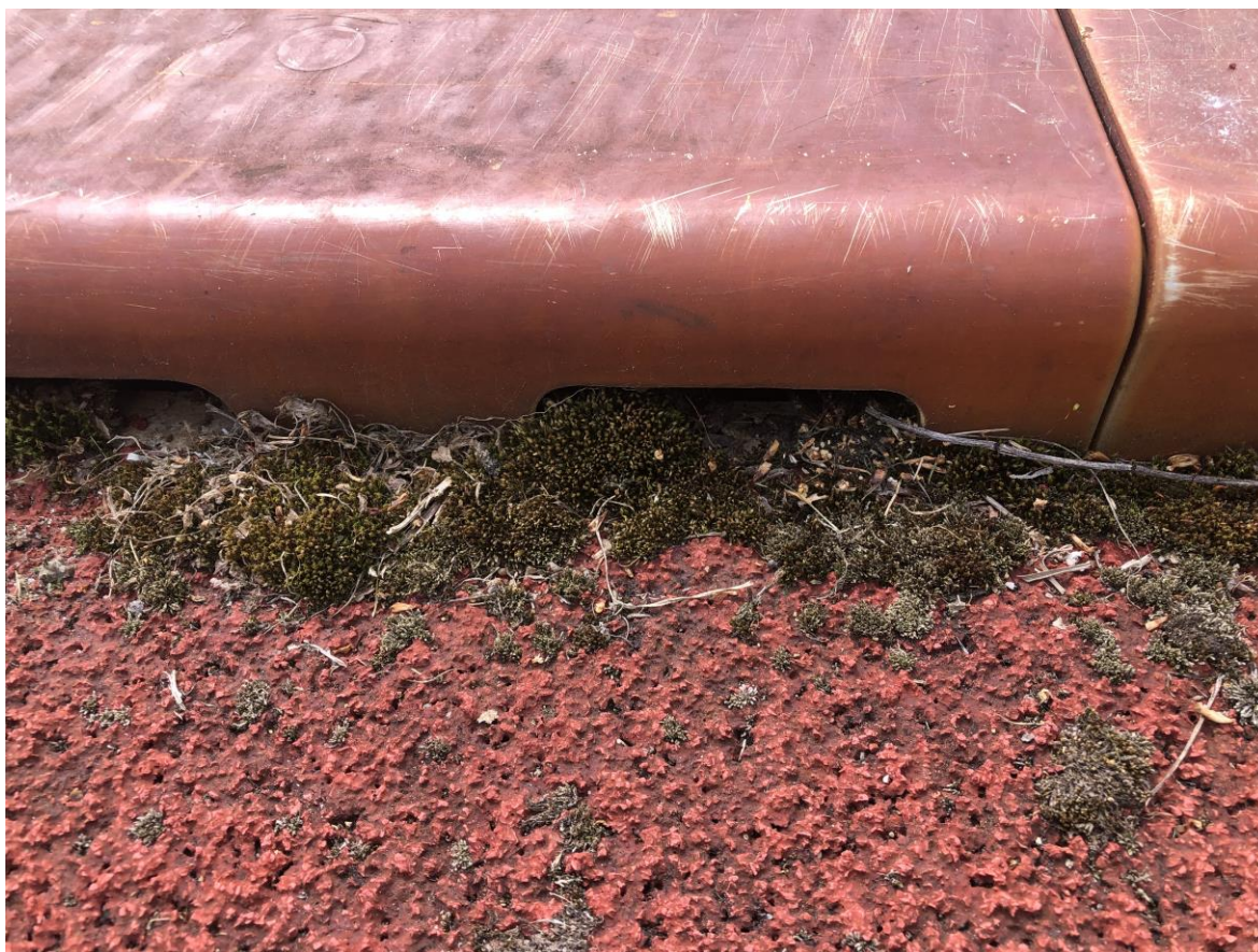
Fot. 6 Nieusunięty mech przy odwodnieniu
