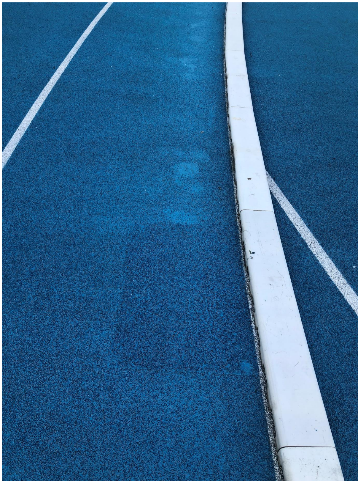
Fot. 20 Przykład lokalnej naprawy nawierzchni – stadion w Nowej Dębie. Nowy fragment charakteryzuje się innymi parametrami dynamicznymi niż nawierzchnia zainstalowana pierwotnie
