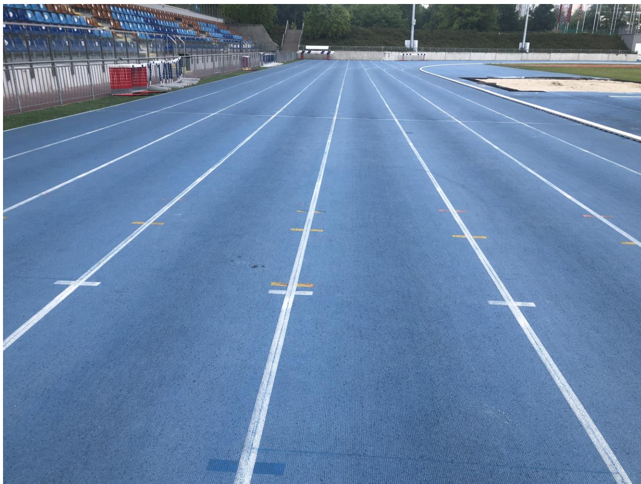
Fot. 8 Wytarcia warstwy użytkowej na środkach torów biegowych
