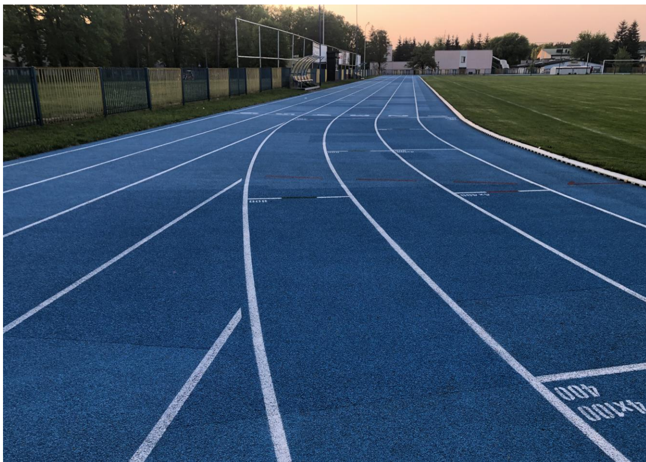
Fot. 6 Linia mety - widoczne liczne wstawki nowych fragmentów nawierzchni
