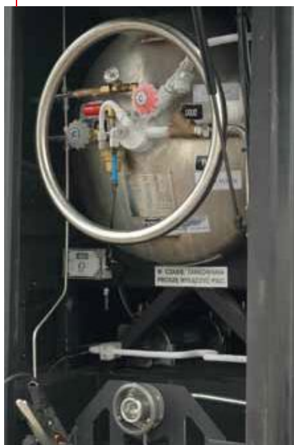
Rys. 7. Widok przygotowanej do tankowania instalacji paliwowej
