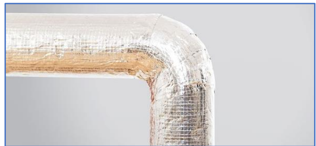
Pic. 3 centrum izolacji: properly insulated elbow joint
