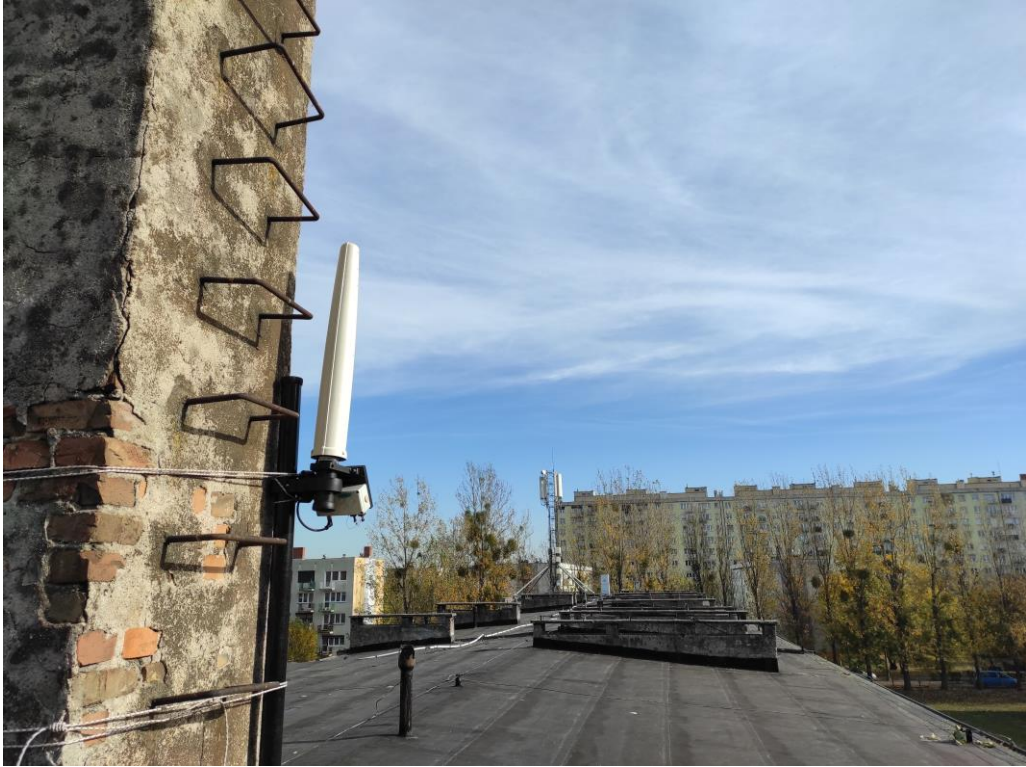
Rys. 2 Miejsce montażu SMS PEM – dach Zespołu Szkół Mistrzostwa Sportowego w Gorzowie Wielkopolskim
