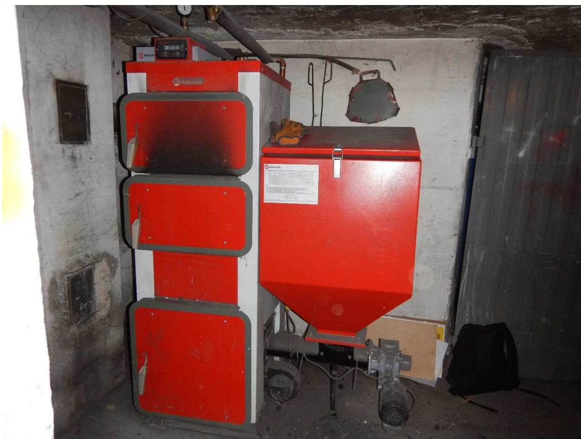
Fot. 12 Piec w kotłowni lokalu nr 2
