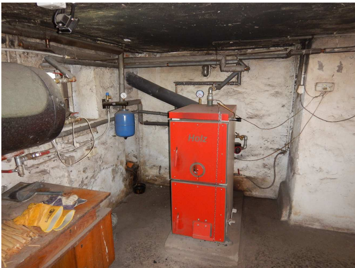
Fot. 11 Piec w kotłowni lokalu nr 1
