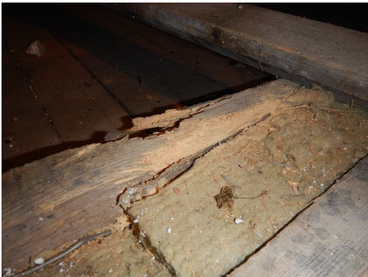
Fot. 15 Kleszcze/Jętki zniszczone przez korniki
