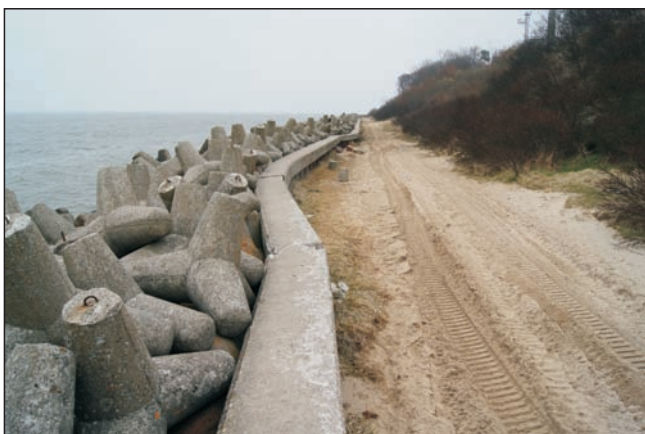
Fig. 2.13. Jarosławiec, ścianka Larsena i gwiazdoblaki przesunięte przez osuwisko
