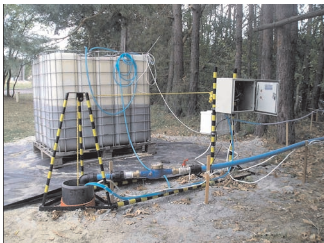
Fig. 16.21. Studnia depresyjna z instalacją wodno-paliwową
