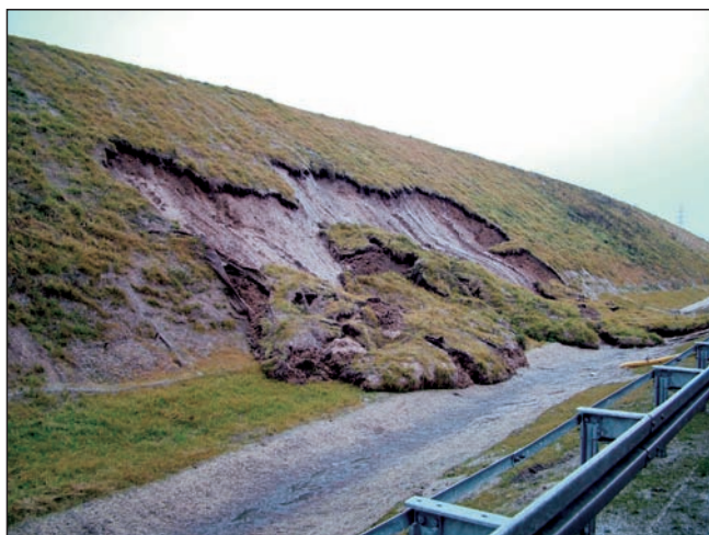
Fig. 2.24. Osuwisko na skarpie wykopu drogi ekspresowej
