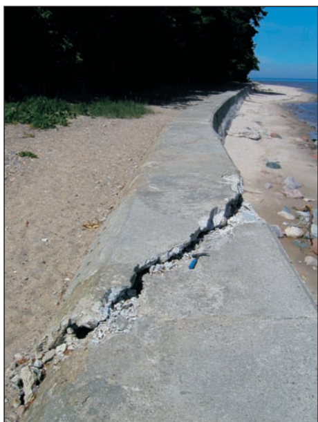
Fig. 2.11. Rozewie, pęknięta opaska betonowa
