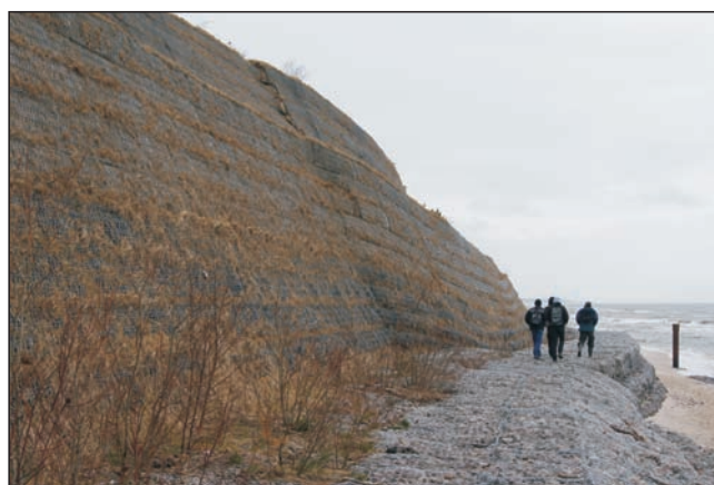
Fig. 2.12. Odształcone zabezpieczenie klifu w Jastrzębiej Górze
