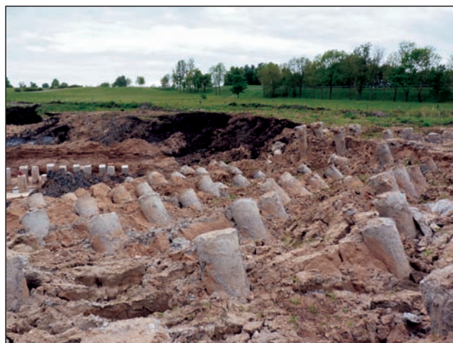
Fig. 2.25. Utrata stateczności na budowie autostrady
