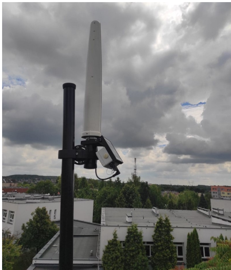
Rys. 2 Miejsce montażu SMS PEM – Szkoła Podstawowa nr 32 w Bytomiu – widok na SBTK
