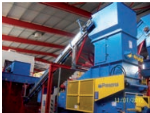
Prasa do belowania odpadów. Fot. ZUOK Stary Las
