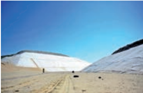
Nowe pole składowe zbudowane w ramach projektu uruchomione w 2009 r. Fot. Maciej Dworżański
