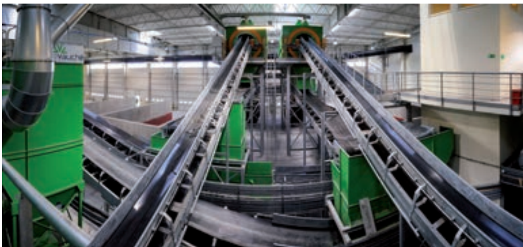
Sita wtórne - dwufrakcyjne. Fot. Zakład Utylizacyjny Sp. z o.o. w Gdańsku
