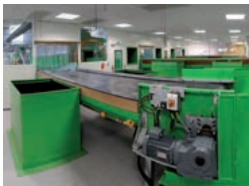
Kabina preselekcji. Fot. Zakład Utylizacyjny Sp. z o.o. w Gdańsku
