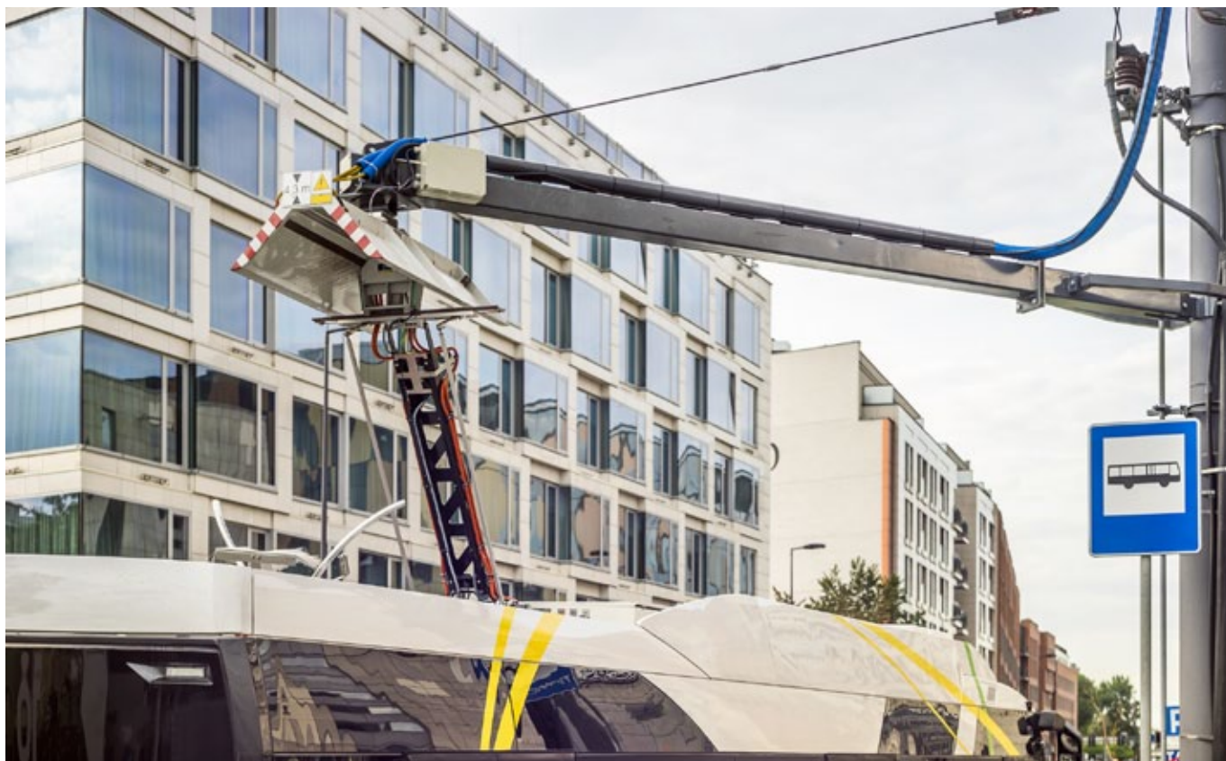
Elektroenergetyczna sieć dystrybucyjna z przyłączem ładowania elektrycznego autobusów miejskich
