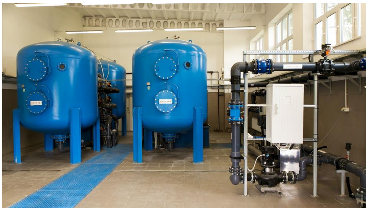
Stacja uzdatniania wody w Więcborku
