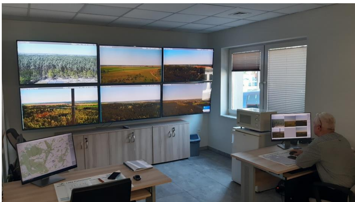
Punkt Alarmowy Dyspozycyjny przy PSP w Złotowie
