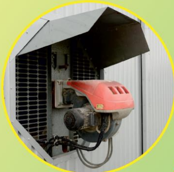
Zabezpieczenie urządzeń elektrycznych przed zawilgoceniem.
