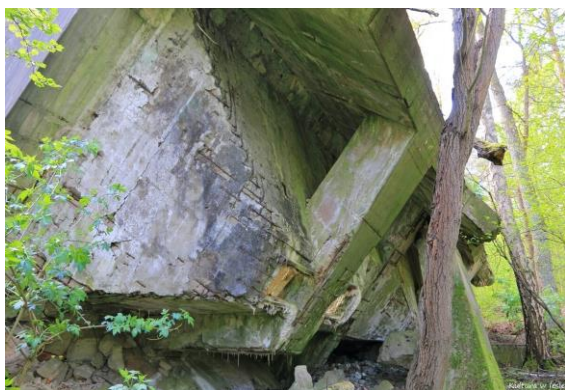
Fotografia 12 Ruiny silosu na prawym (północnym) brzegu Ilanki
