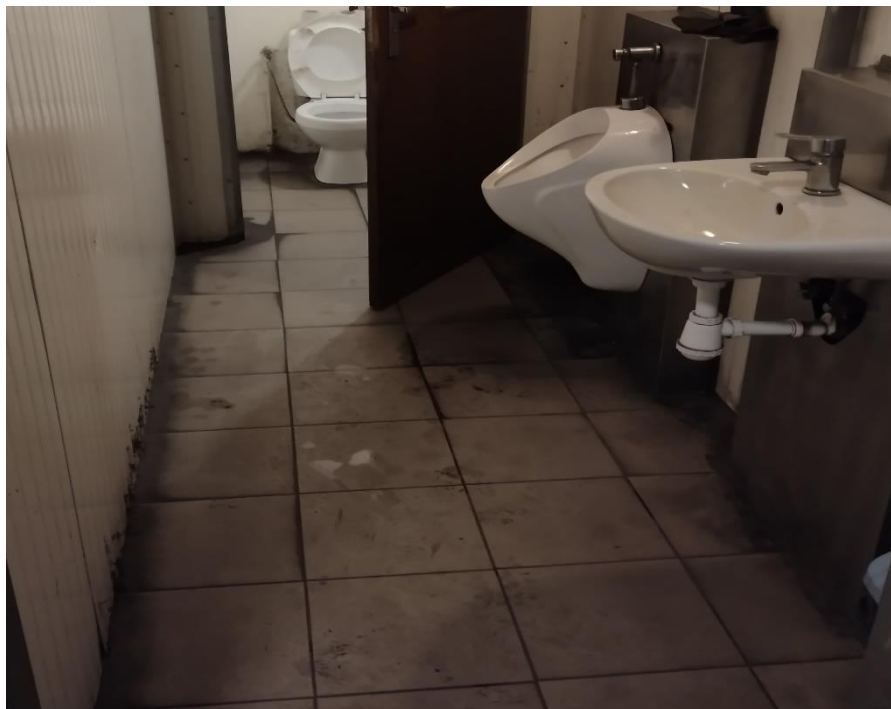
Stan pomieszczenia toalety stwierdzony podczas kontroli sanitarnej
