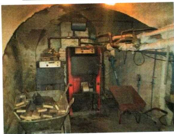
kotłownia w piwnicy
