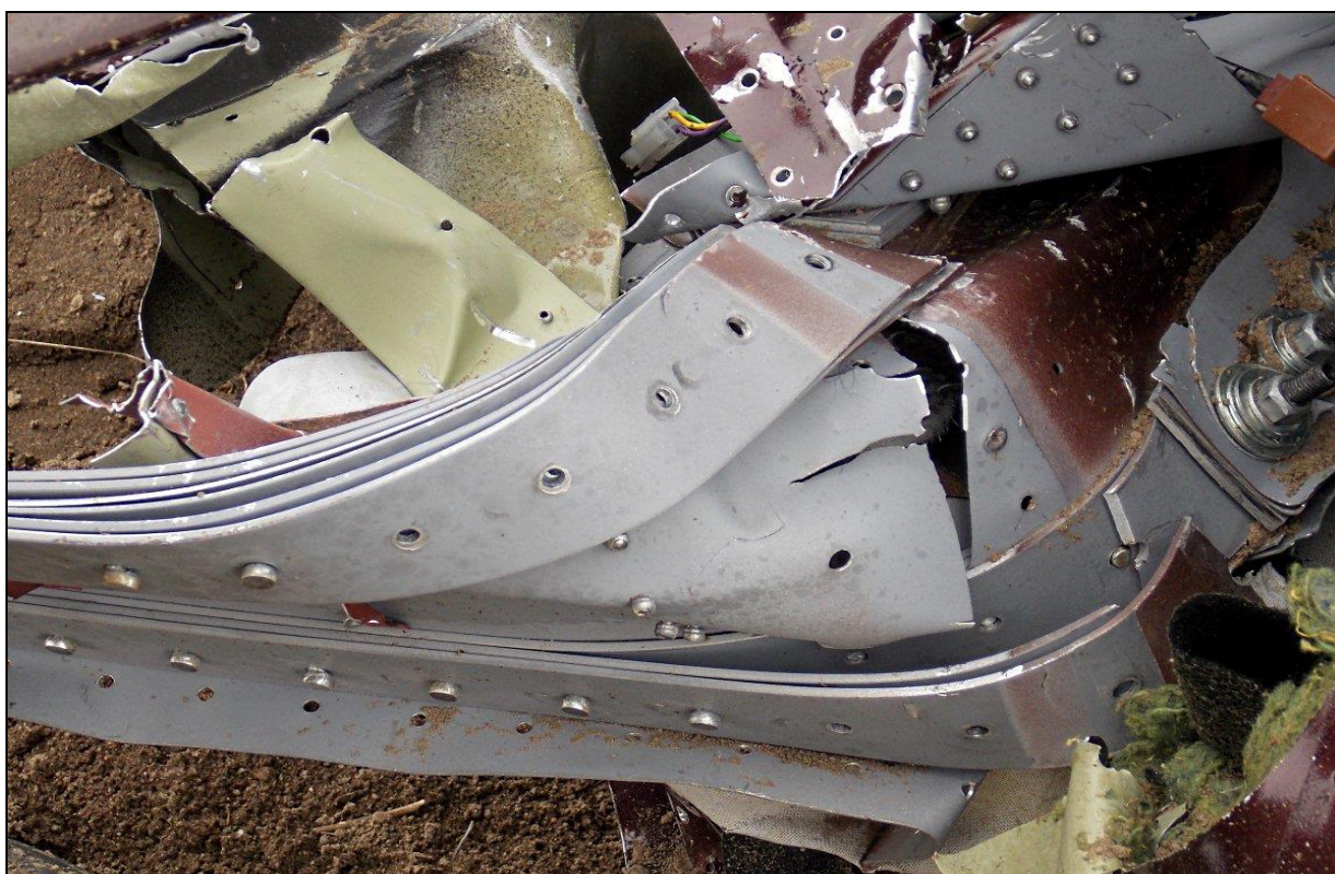
59 – Dźwigar prawego skrzydła w miejscu zgięcia przy kadłubie. Dobrze widoczna konstrukcja pasa dźwigara z wielu nakładek. Widoczne praktycznie całkowite jego złamanie i zerwanie na zgięciu.
