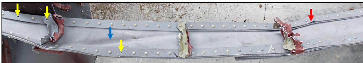
53 – Fragment zniszczonego dźwigara prawego skrzydła. Niebieską strzałką wskazane odkształcenie od skręcania, czerwoną – lokalne wyboczenie konstrukcji pasa dźwigara, strzałkami żółtymi wskazano ścięte nity.
