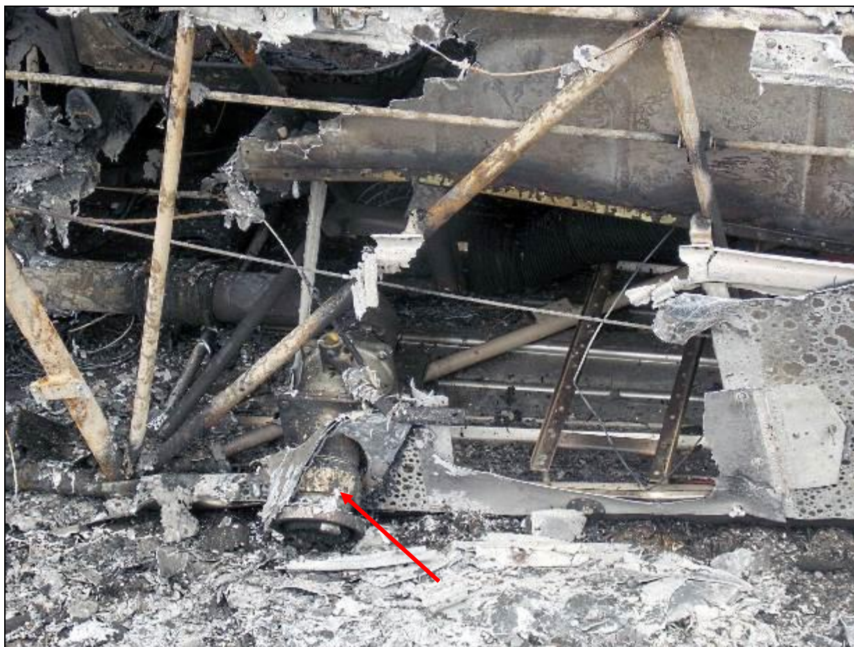
60 – Zawór ciśnieniowego napełniania zbiornika chemikaliów.
