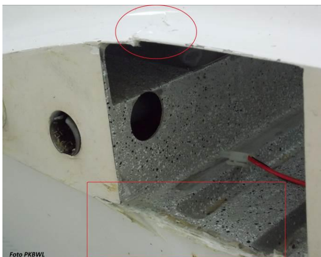
Ilustracja nr 4. Uszkodzone poszycie kadłuba w rejonie przejścia skrzydło - kadłub.
