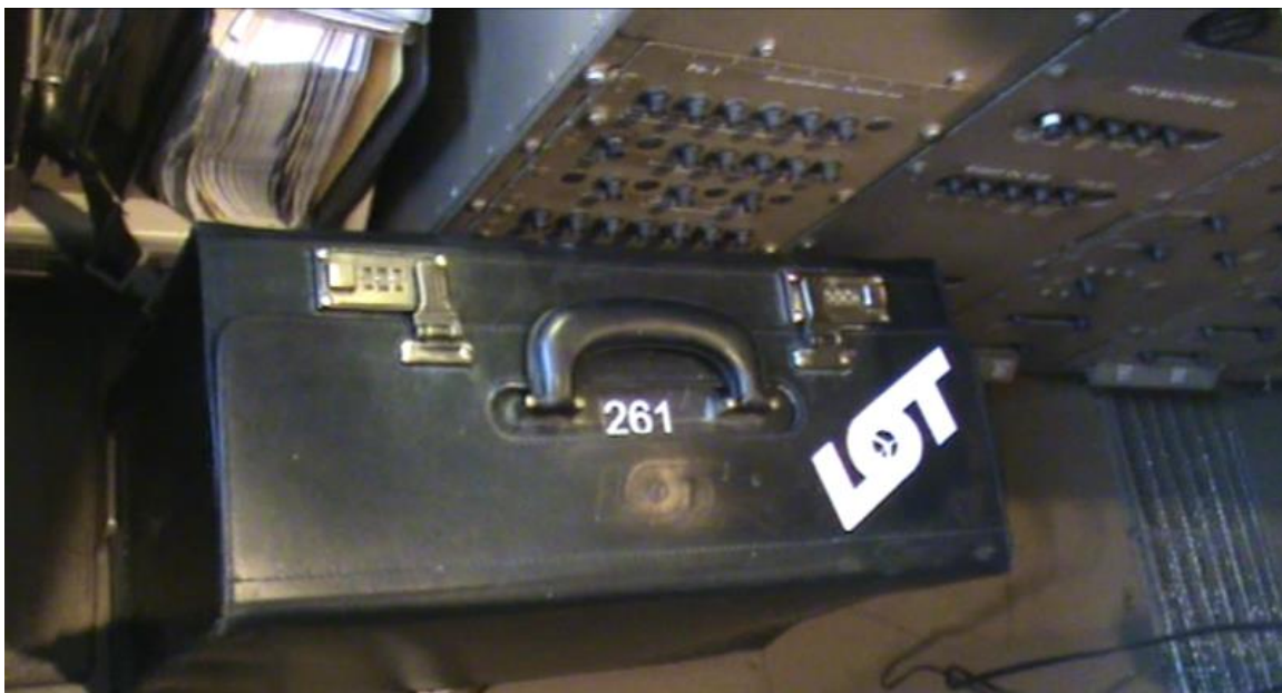
Ilustracja 4. Widok z fotela FO na panel bezpieczników P6 z walizką
