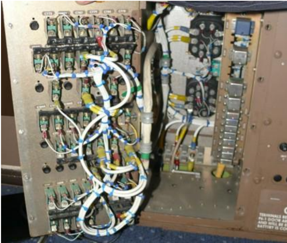
Ilustracja 7. Widok wewnętrznej strony tablicy P6-1
