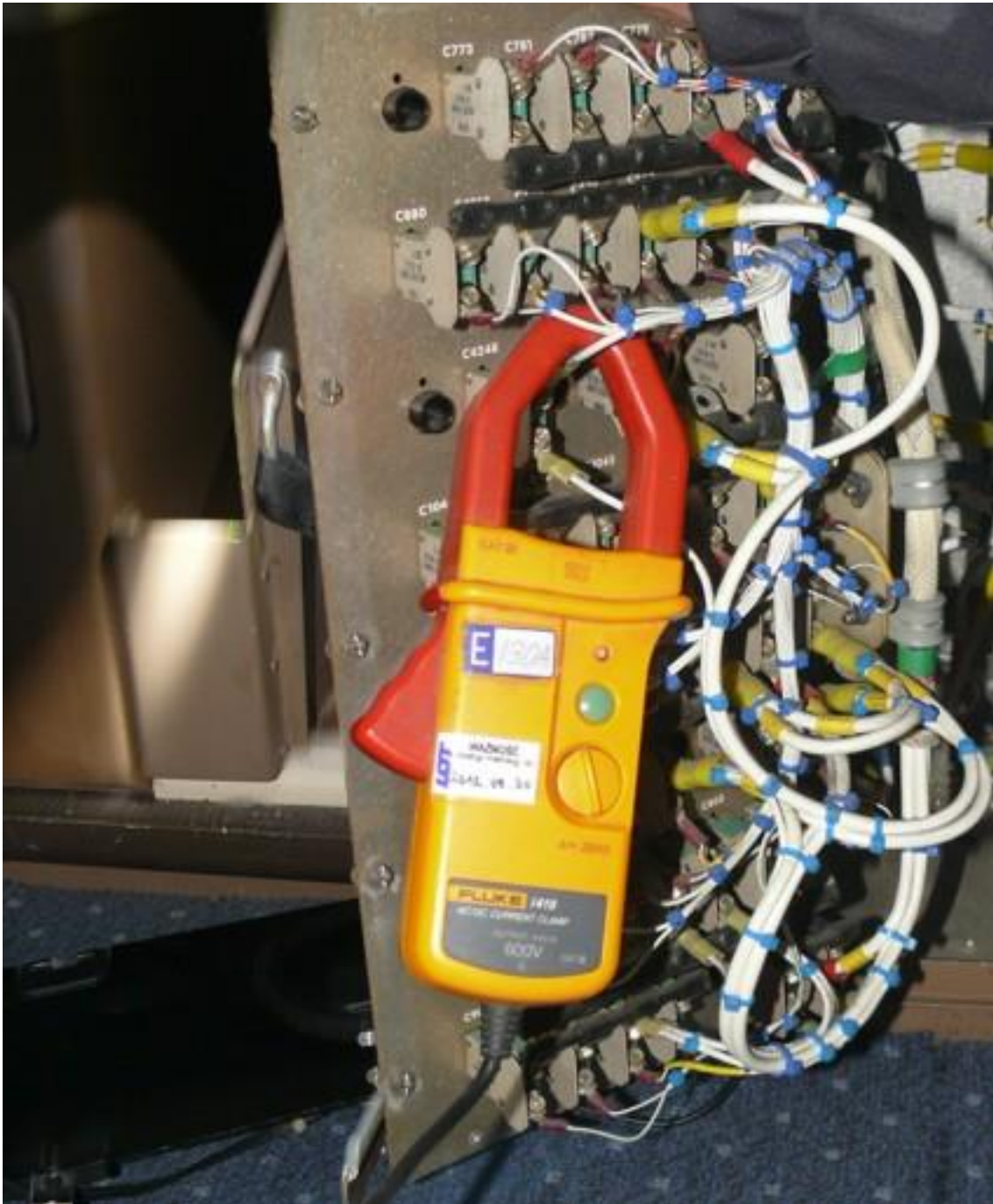
Ilustracja 6. Podłączenie cęgów pomiarowych do obwodu bezpiecznika C4248
