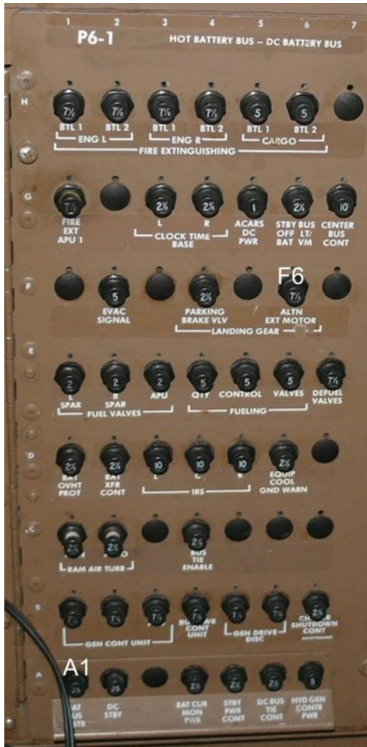
Ilustracja 1. Panel bezpieczników P6-1. Na pozycji A1 bezpiecznik C829 BAT BUS DISTR
