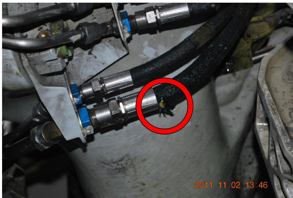
Ilustracja 23. Zbliżenie uszkodzenia przewodu hydraulicznego (zaznaczone czerwonym okręgiem) na prawym podwoziu głównym samolotu SP-LPC. (Źródło – PKBWL)
