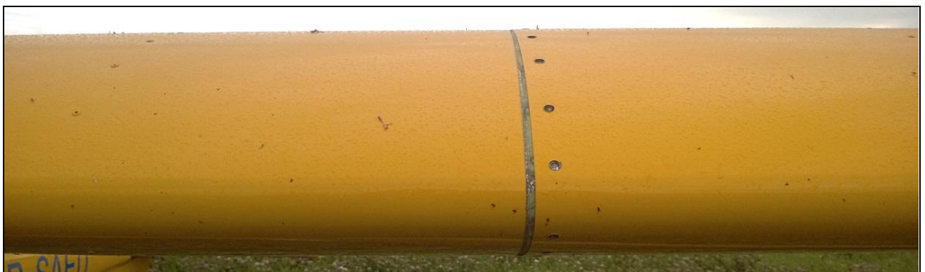
4 – Ścięty szew nitowy na połączeniu arkuszy blach pokrycia noska.
