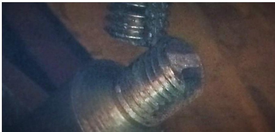
Ilustracja nr 3. Pęknięcie - przelom gwintowanej końcówki regulacji długości popychacza steru wysokości.
