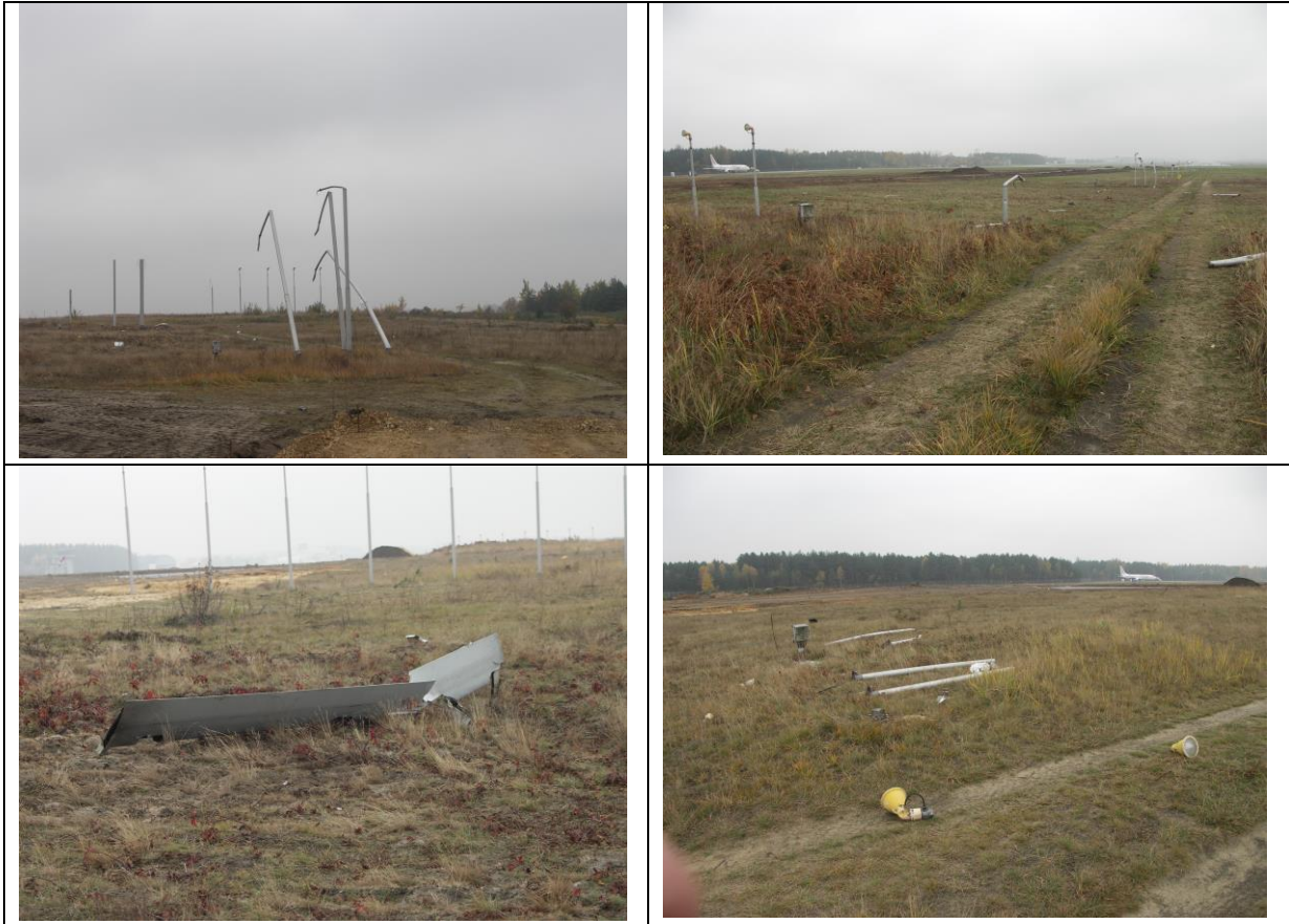
Ilustracje 7-10. Uszkodzenia świateł podejścia na lotnisku EPKT
