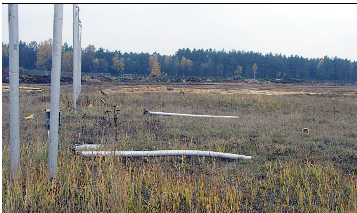
19 – Zniszczenia układu świateł podejścia przed progiem RWY27 lotniska EPKT po wypadku
