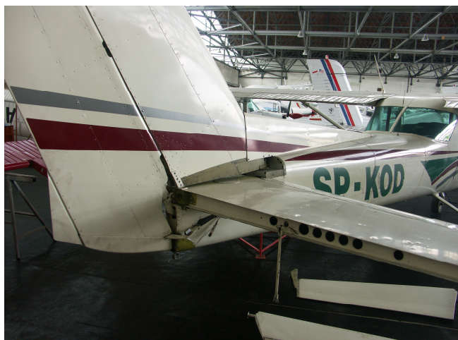
Rys. 4 Weryfikacja uszkodzeń tyłu kadłuba widok z tyłu..
