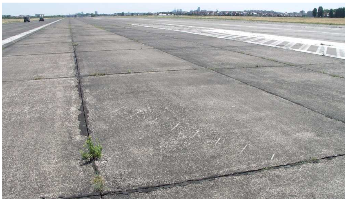
6 – Ślady łopat śmigła na nawierzchni pasa startowego.
