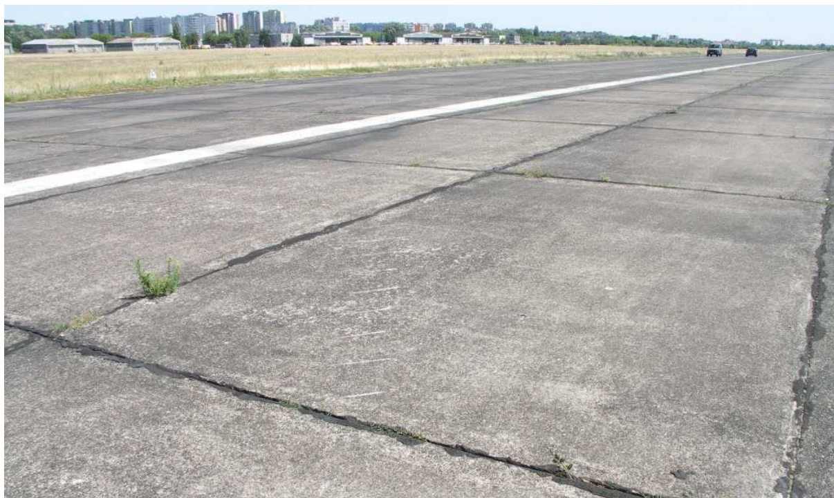
5 – Ślady łopat śmigła na nawierzchni pasa startowego.
