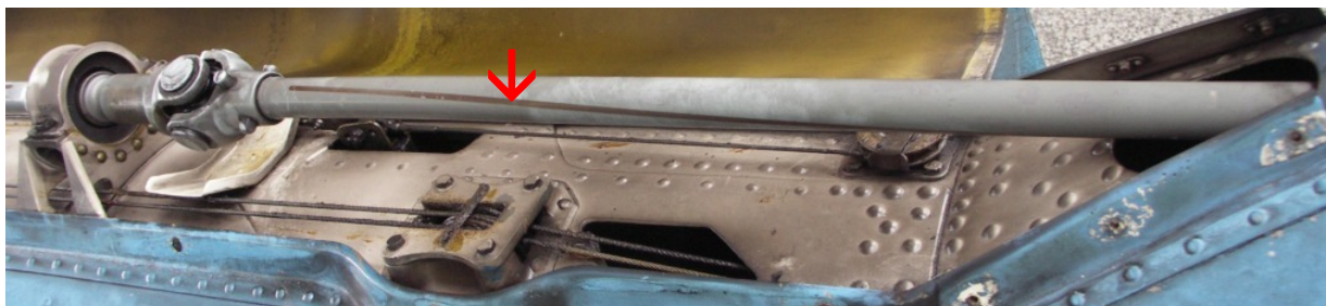
10 – Trwałe skrzywienie ostatniego odcinka wału napędowego wirnika ogonowego na belce ogonowej – widać skrzywienie brązowej linii na wale.
