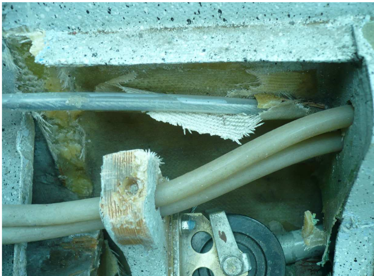
35 – Wyłamane elementy konstrukcji w zbliżeniu.
