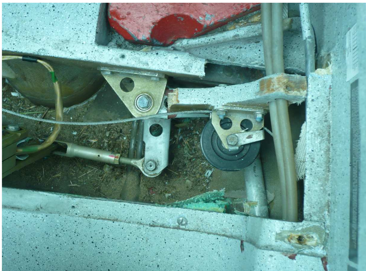
31 – Prawa strona przedniej kabiny po zdjęciu osłony układu sterowania ręcznego. Widoczna pęknięta wręga.
