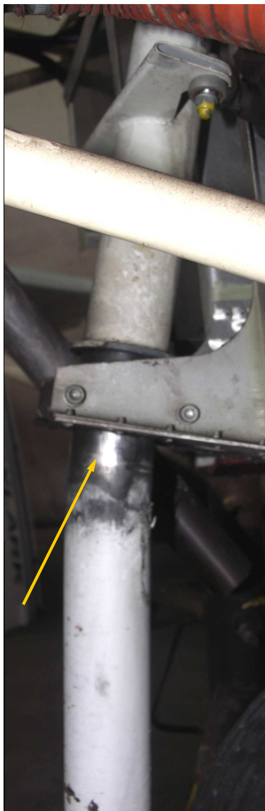
21 – Górna część goleni podwozia przedniego z lewej strony. Dobrze widoczne jej odkształcenie (zgięcie) i kontaktowe zużycie przy dolnym węźle mocowania (strzałka).
