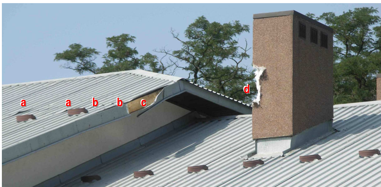
20 – Uszkodzenia pokrycia dachu [znieskształcenie blachy -a, rysa na blasze -b, zerwanie obrzeża -c] i komina [-d].
