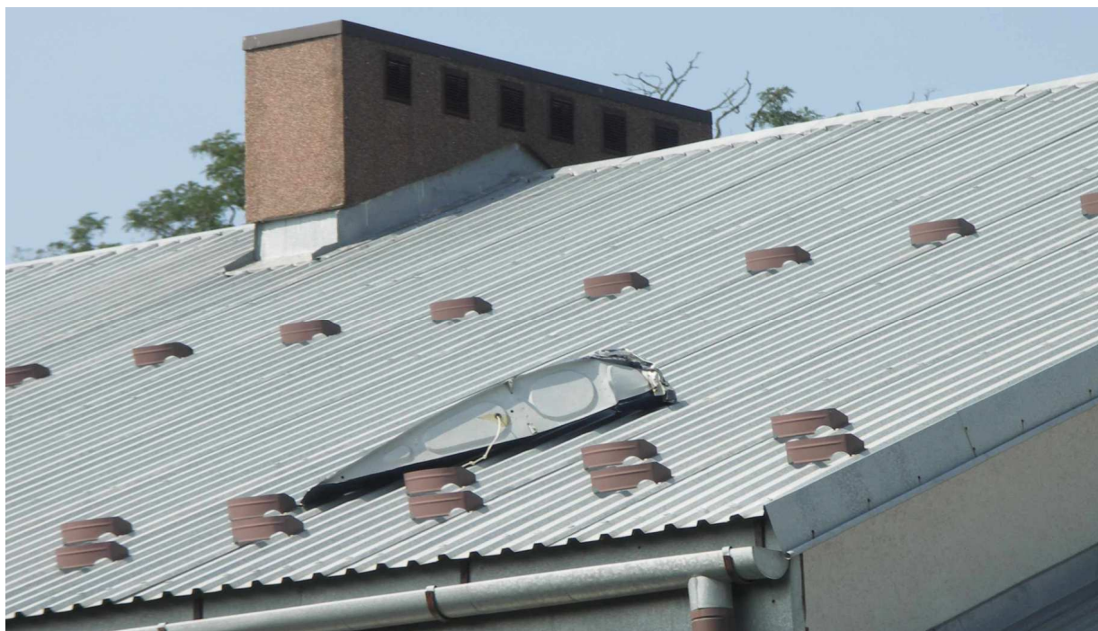
19 – Oderwana wskutek uderzenia o komin końcówka lewego skrzydła na dachu budynku nr 96.
