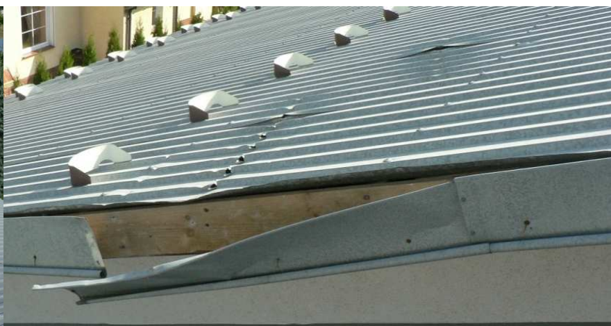
22 – Uszkodzenia pokrycia i obrzeża dachu – zbliżenie.
