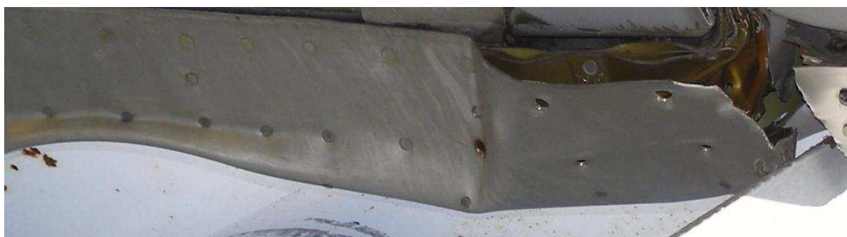
12 - Uszkodzenie krawędzi natarcia lewego skrzydła-widok z dołu.
