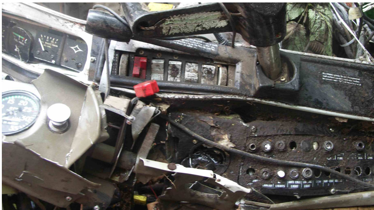
21 – Zbliżenie na prawą stronę pulpitu poziomego z przełącznikami i bezpiecznikami instalacji elektrycznej. Widoczny wyłamany wolant.
