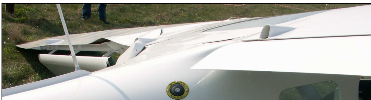
12 – Widok na klapy prawego i lewego skrzydła. Widoczne zniszczenia lewej klapy i pokrycia lewego skrzydła.
