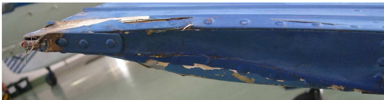
13 – Uszkodzone żebro końcowe prawej końcówki steru wysokości i pokrycia w jego sąsiedztwie. Oderwany rozładowywacz ładunków elektrostatycznych.
