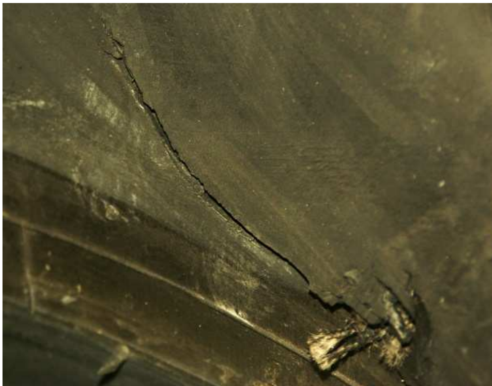
34. Zbliżenie uszkodzenia z oznacz. 2.
