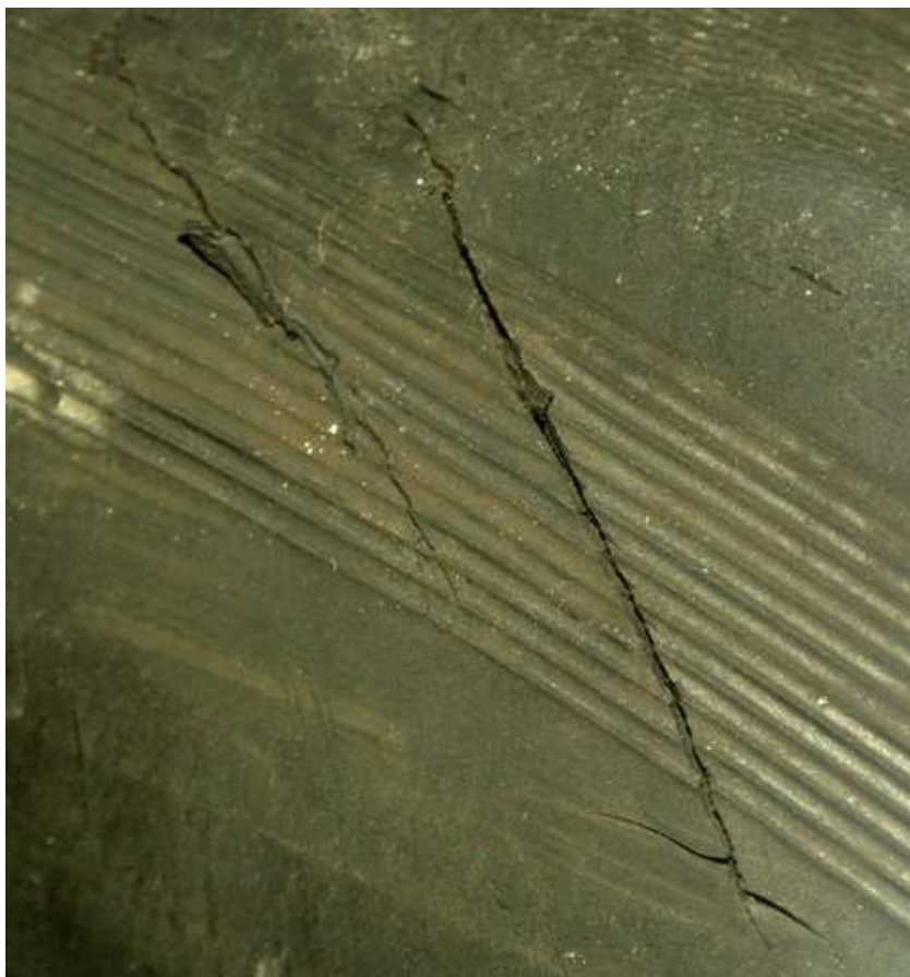
36. Zbliżenie uszkodzenia z oznacz. 4.
