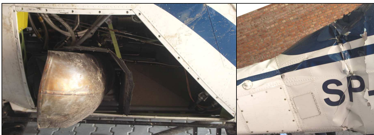
27 – Wgnieciona rura wylotowa spalin turbiny. Pokrywa kadłuba zdjęta, widoczne linki sterowania wirnikiem ogonowym [fot.PKBWL].
