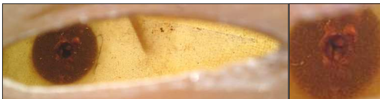
37 – Dno zbiornika i wylot paliwa do przewodu, widziane przez wycięty w płaszczu zbiornika otwór. Zanieczyszczenia pochodzące z paliwa wyraźnie widoczne.
