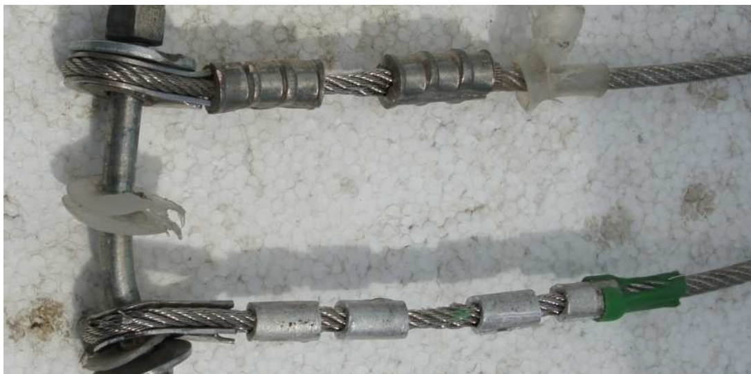
Fot. 4. Widok jednej linki przedniej i jednej linki tylnej sterownicy zabezpieczone na miejscu wypadku. Uwagę zwracają nieoryginalne zakucia i osłonki zakuć.
