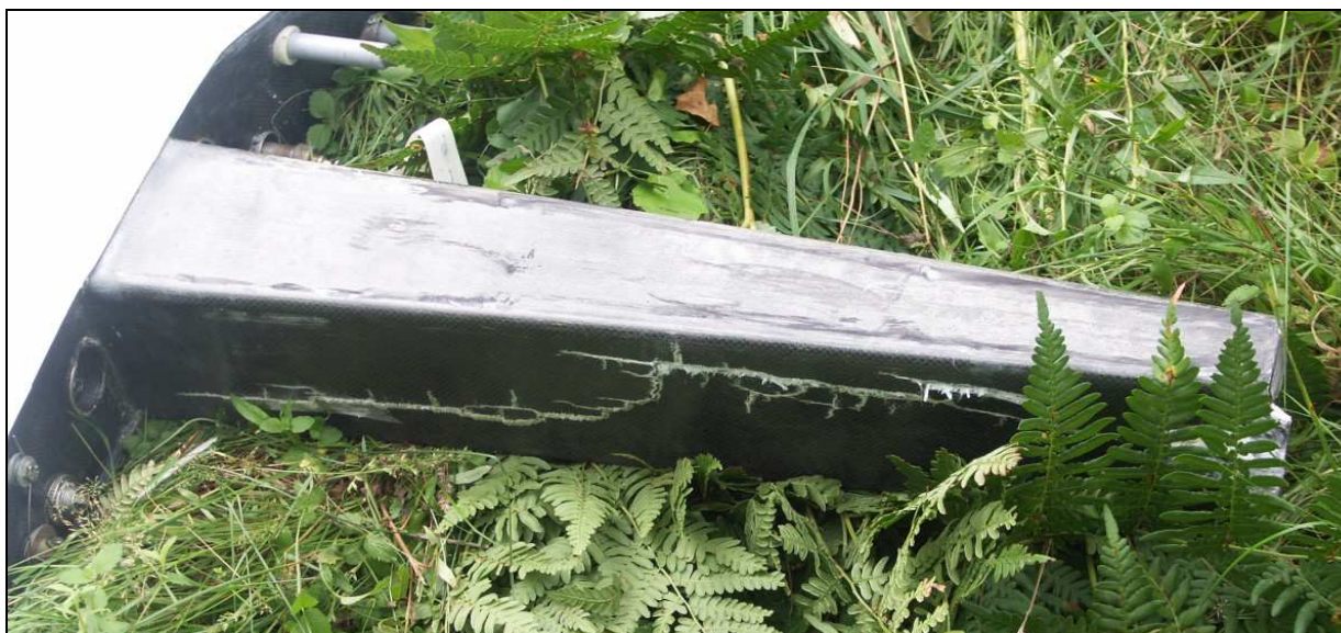
31 – Odłamane prawe skrzydło, nasadowa część dźwigara z widocznymi pęknięciami.
