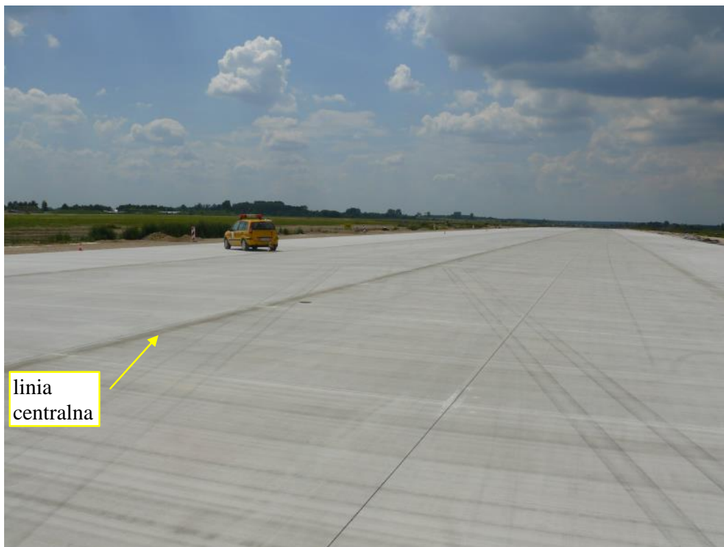
Fot. 12. Ślady zatrzymania samolotu na budowanej drodze startowej (~2700[m] od początku nawierzchni 27).
