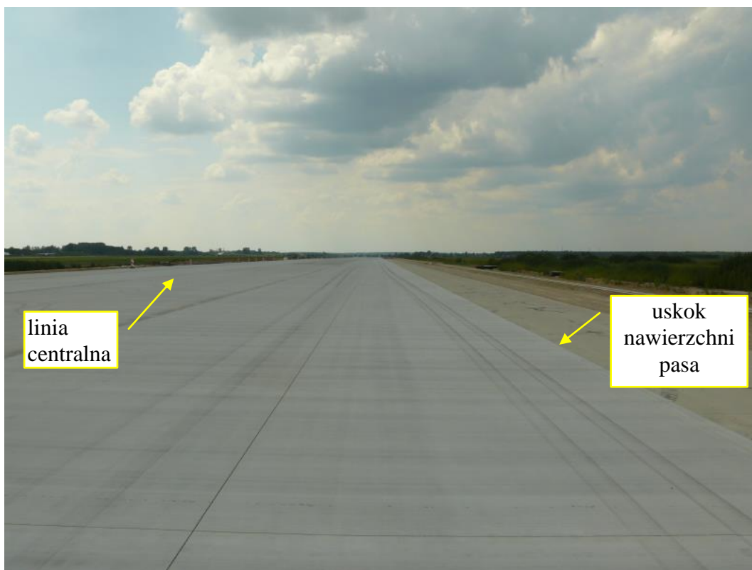
Fot. 9. Ślady maksymalnego zbliżenia się samolotu do krawędzi (odległość 1[m] od uskoku) wykonanej nawierzchni drogi startowej.
