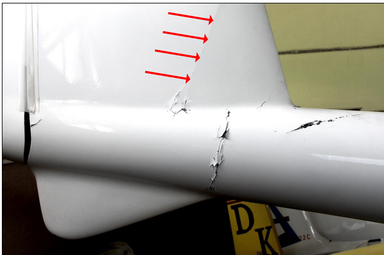
42 – Uszkodzenia (pęknięcia) pokrycia belki ogonowej u nasady statecznika pionowego, prawa strona kadłuba. Widoczne załamanie pokrycia statecznika pionowego (strzałki czerwone).
