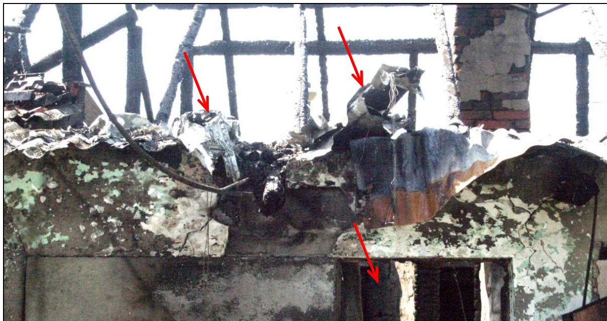
37 – Sień domu przy ul.Podstawie 27 ze zniszczonym dachem. Strzałkami wskazane szczątki lewego skrzydła.
