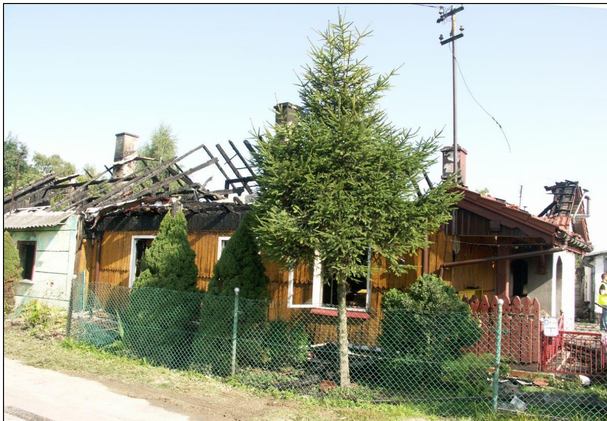
39 – Domy przy ul.Podstawie 27 i 27a następnego dnia po wypadku – widok od strony południowo-wschodniej.
