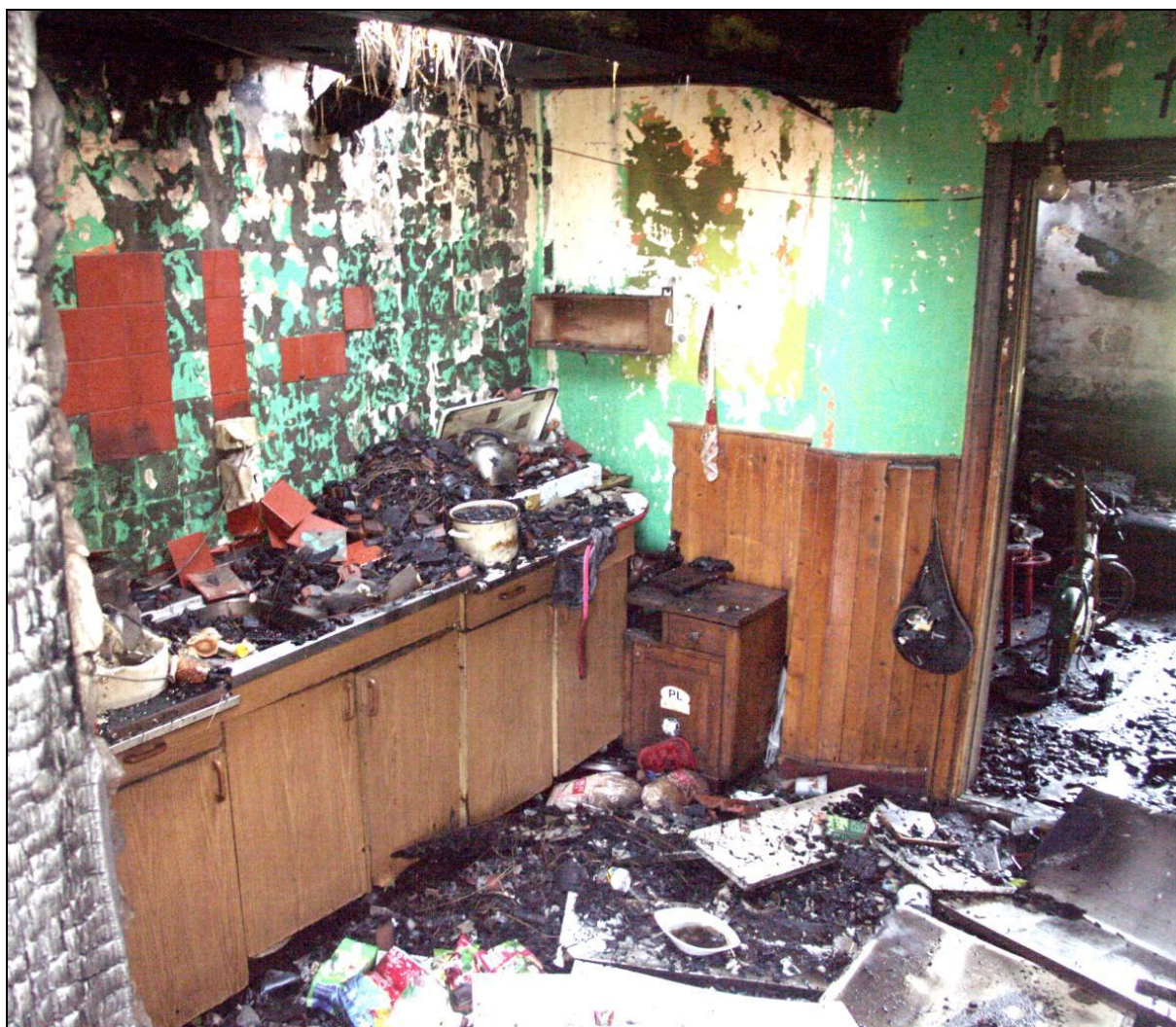
38 – Wnętrze kuchni w domu przy ul.Podstawie 27, zniszczonej wskutek pożaru i akcji gaśniczej.
