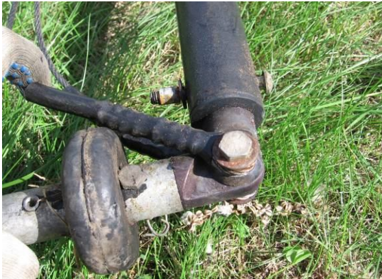
Foto 9. Korozja podkładek i linek bocznych (życiówek) w prawym węźle bocznym sterownicy
