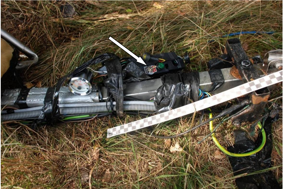
Foto 17. Fragment układu elektrycznego z widocznym włącznikiem głównym
