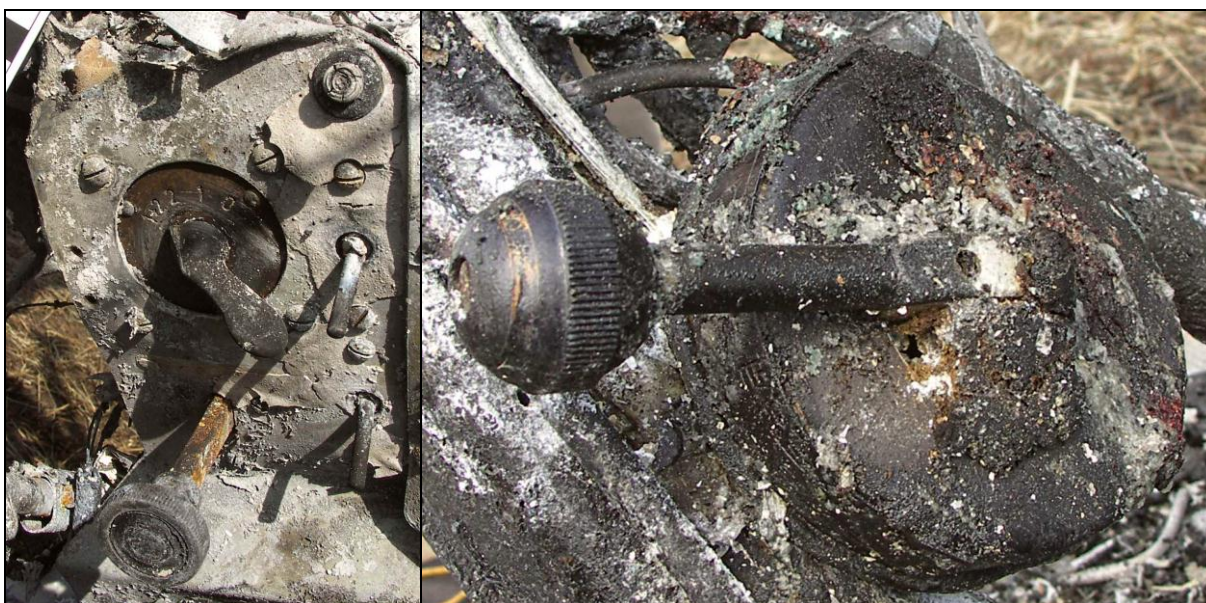
38 – Przełącznik iskrowników (w położeniu „1+2”).
