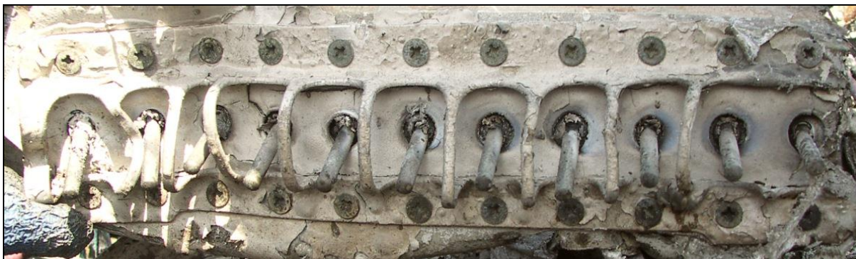
37 – Pulpit z przełącznikami instalacji elektrycznej.
