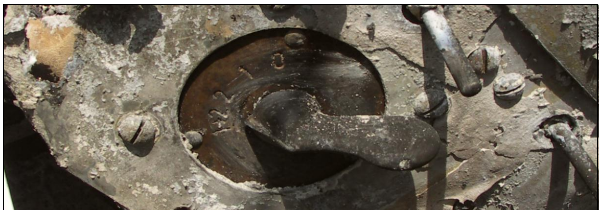
Przełącznik iskrowników w położeniu „oba włączone” (1 + 2).
