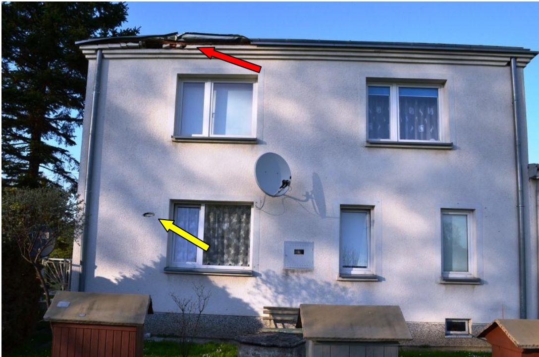
Fot. 4. Uszkodzenia budynku mieszkalnego. Żółta strzałka wskazuje miejsce pierwszego uderzenia. Czerwona strzałka wskazuje miejsce zaczepienia o krawędź dachu. Fot. PKBWL.
